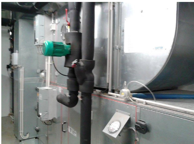
Slika 10: Del klimatske naprave (Vir: lasten)
