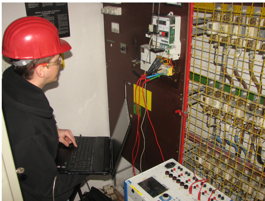
Slika 5.15: Kontrola števca električne energije po 75. členu SONDO [30]
