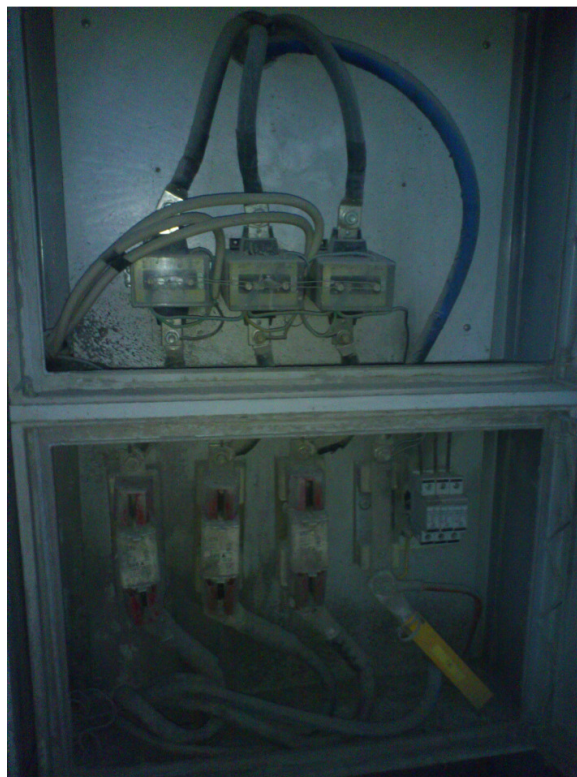
Slika 5.19: Poškodovani tokovni merilni transformatorji z nerazpoznavnimi napisnimi tablicami [30]
