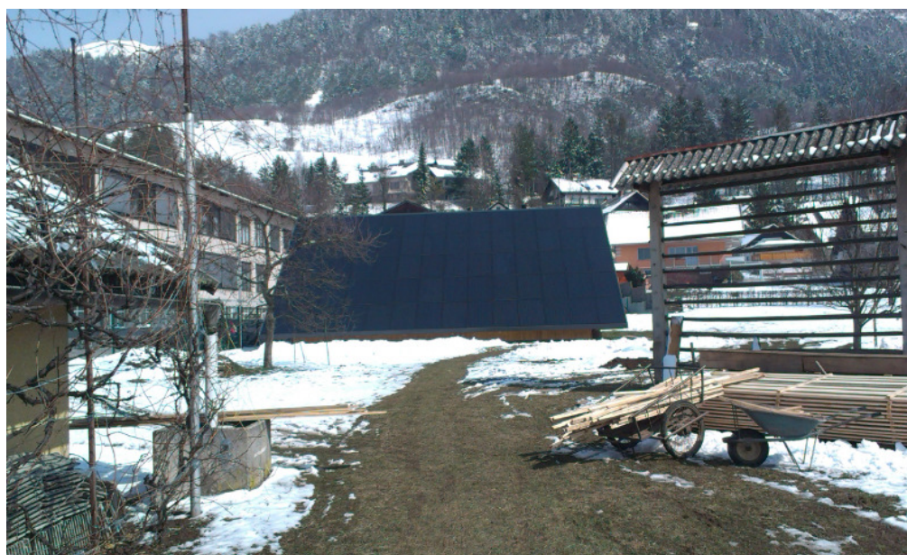
Slika 5.22: Mala sončna elektrarna Ovsenik 2 [30]
