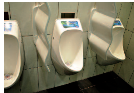
Čprav za trajnostno odgovornostjo ne stoji le skrb za okolje, so si v Monsu omislili tudi "eko pisoarje", to so pisoarji brez vode, ki pa imajo vstavljen poseben prečiščevalni filter. Nameščeni so v moški toaleti v kongresnem centru.
