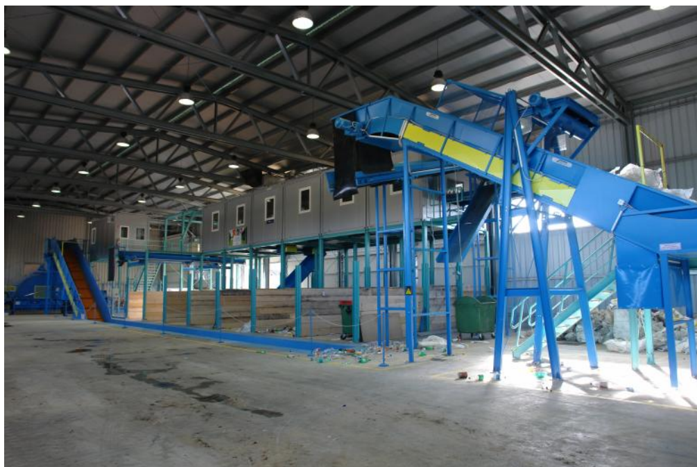
Slika 1.1: Projekt MD Inženiring d.o.o.; center za ravnanje z odpadki – RCERO Gajke Ptuj
