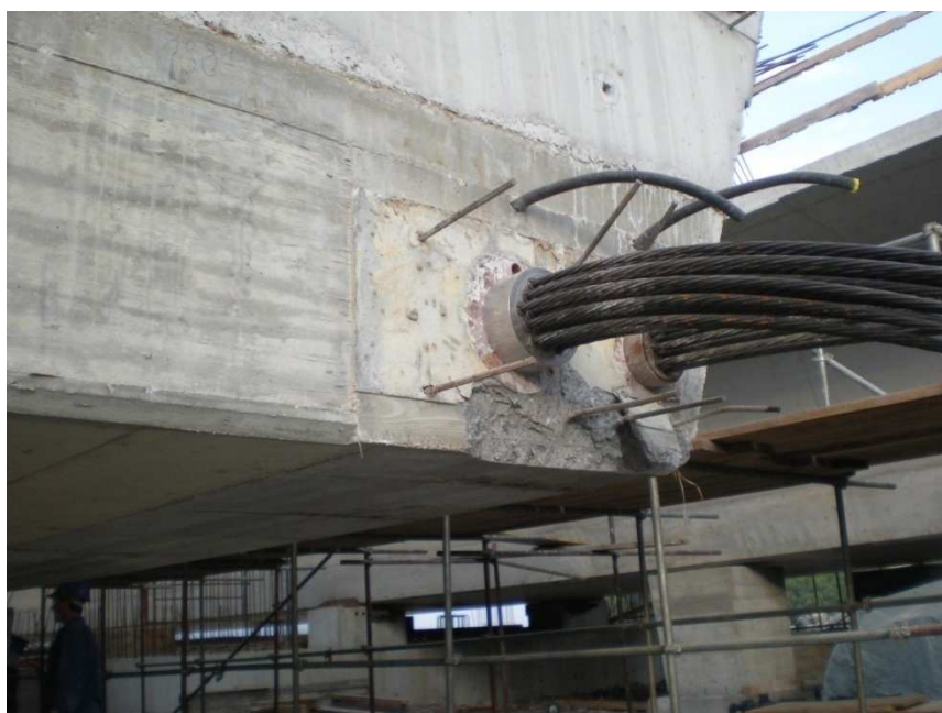
Slika 5.2: Poškodba zaščitnega sloja betona pri zadnjem narivanju
