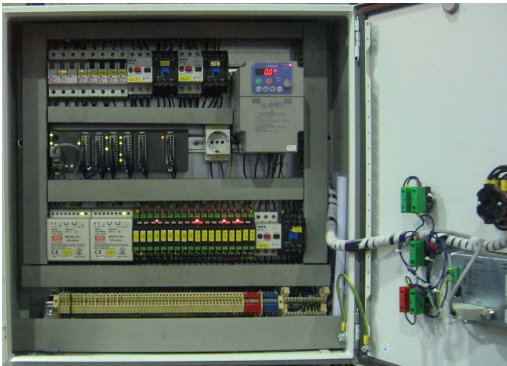
Slika 3.17: Izgled elektro omare
