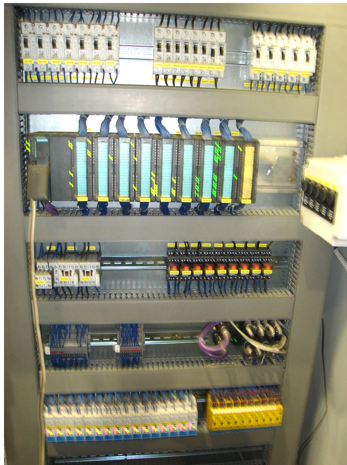
Slika 3.4: Notranjost elektro omare
