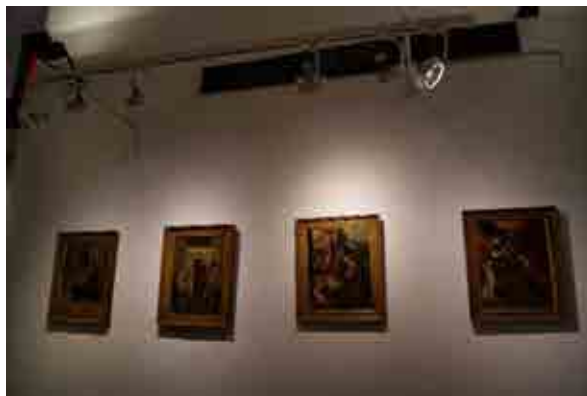
Rieles con focos de led anclados a los muros en la Saleta de los Flamencos. Testero este.
