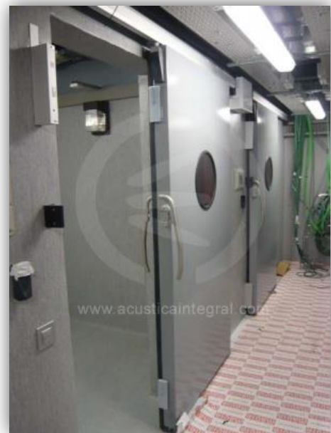
Figura 38 Puerta acústica deslizante
