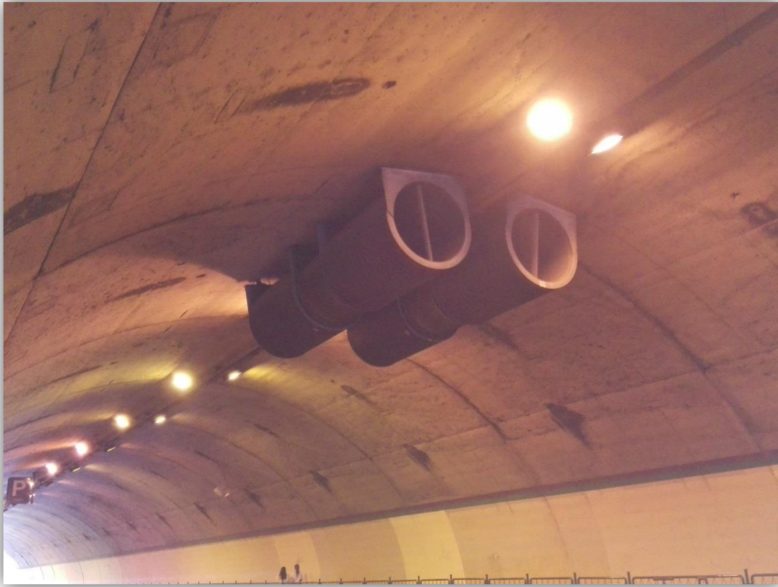
Figura 125 Detalle de los extractores del túnel
