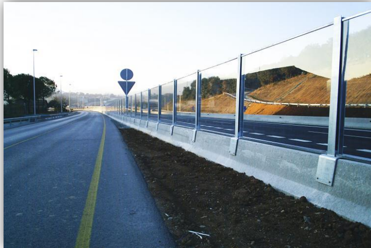
Figura 20 Barreras acústicas instaladas
