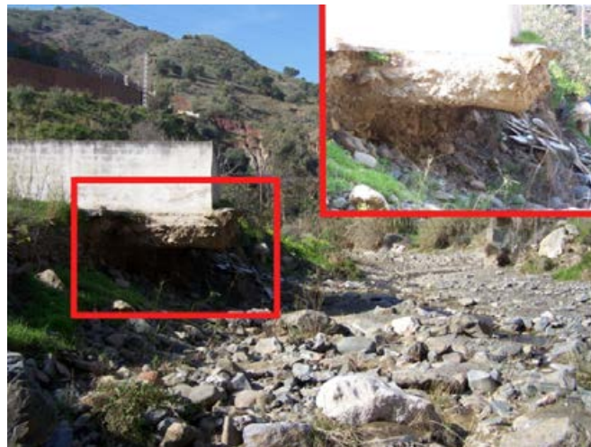
Figura 14. Arroyo Jaboneros (noviembre de 2006): Muestra de la situación en que quedó una edificación precaria situada en la llanura de inundación tras el evento. Fuente: Francisco Cantarero Prados.
