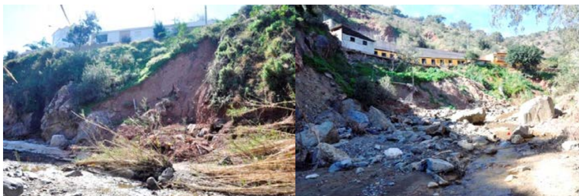
Figura 22. Procesos activos en laderas situadas en meandros del arroyo Jaboneros, localizados en los contactos entre distintas litologías. Apréciase la precariedad en la que quedan diversas construcciones del periurbano de la capital. Fotos: autor.
