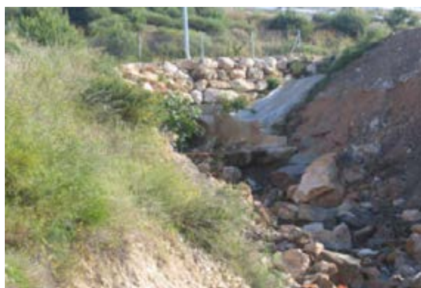
Figura 17. Arroyo Pollo Zamora (marzo de 2004): Bloques de gran volumen, en buena parte relacionados con escolleras artificiales, arrastrados hasta el cauce del arroyo Pollo Zamora durante el evento. Fuente: Junta de Andalucía.
