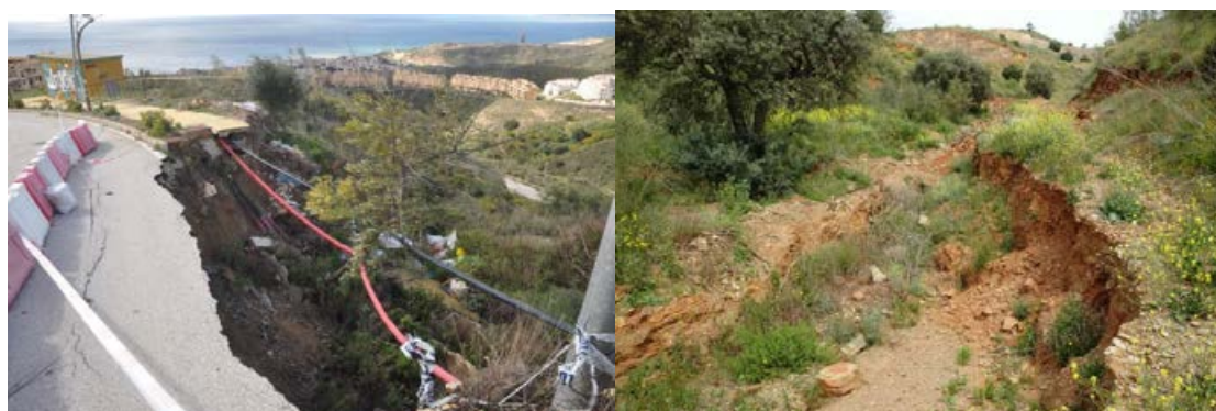
Figura 23. En la imagen de la izquierda puede observarse un importante deslizamiento de ladera que coincide con una zona de relleno para construcción de vial en la cuenca del Arroyo Pollo Zamora. En la imagen de la derecha, evidencias de erosión lateral del cauce del arroyo Piletas. Fotos: autor.
