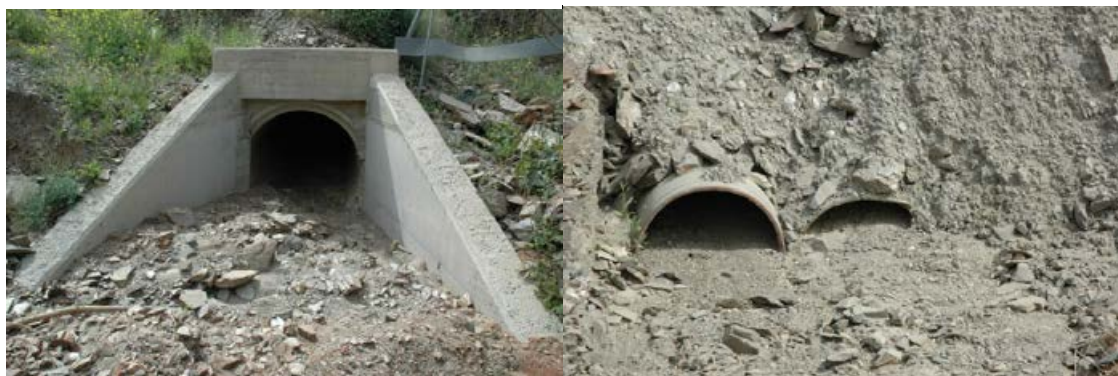
Figura 2. Imagen izquierda: acumulación de sedimentos heterométricos en una de las obras de paso de la cuenca del arroyo Piletas. Imagen derecha: aterramiento casi completo en entubamientos del cauce del arroyo Pollo Zamora. Fotos: autor.
