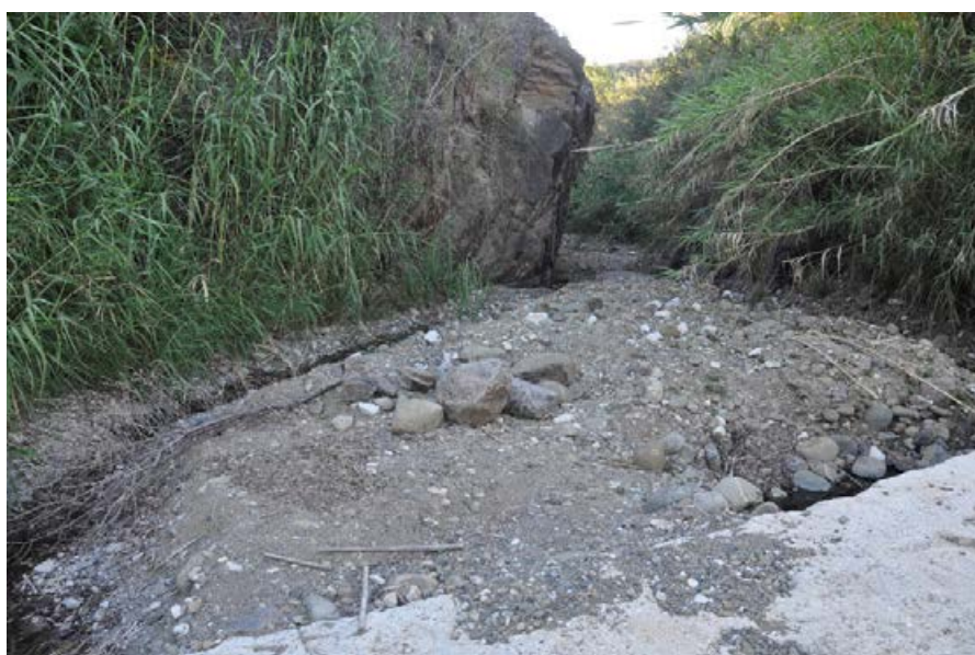
Figura 3. Detalle de un estrechamiento puntual del cauce del río de la Cala. La angostura se sitúa unos metros antes del cruce con un vial asfaltado, que se convierte con ello en un punto donde confluyen una alta vulnerabilidad y alta peligrosidad por la posible formación de colapsos. Foto: autor.
