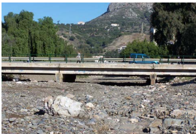
Figura 9. Arroyo Jaboneros (noviembre de 2006): Colmatación con sedimentos y material sólido heterométrico en un puente próximo a la desembocadura. Fuente: Francisco Cantarero Prados.
