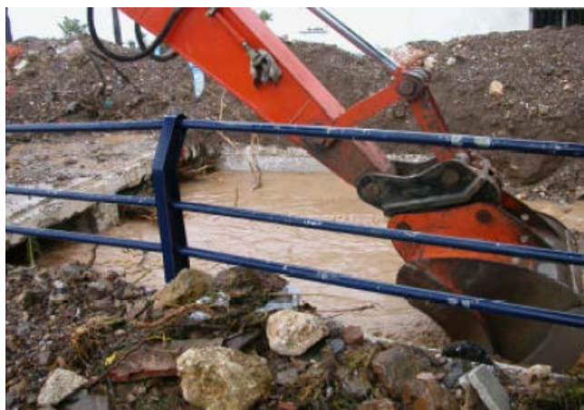
Figura 16. Arroyo Piletas (marzo de 2004): máquina retroexcavadora retirando restos sólidos del cauce que taponaron una obra de paso. Fuente: Junta de Andalucía.
