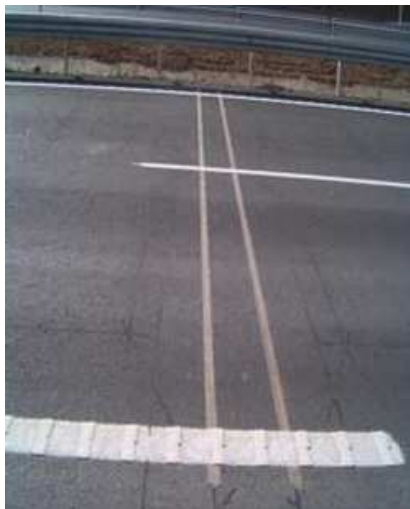
Figura 22. Sensores de presencia en calzada
