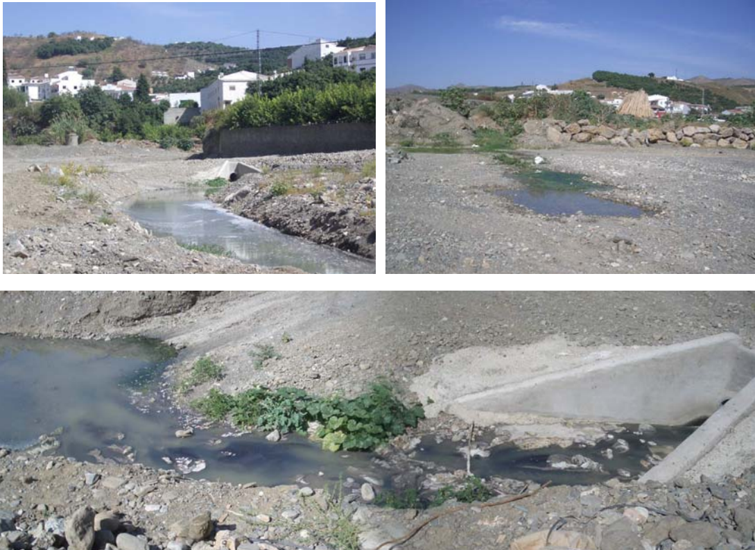
Foto 10.5. Vertido de aguas residuales en la localidad de Benamargosa (arriba izquierda) y barriada de Triana (arriba derecha). Abajo detalle del vertido de las aguas residuales urbanas de Benamargosa.
