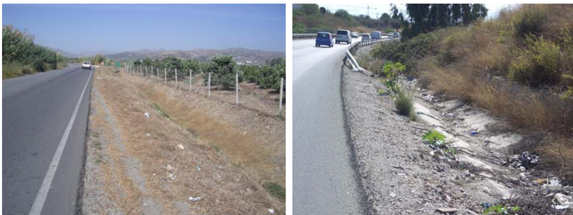
Foto 10.9. Carretera sin canal de desagüe (izquierda) y con canal de evacuación de líquidos hacia el acuífero (derecha).
