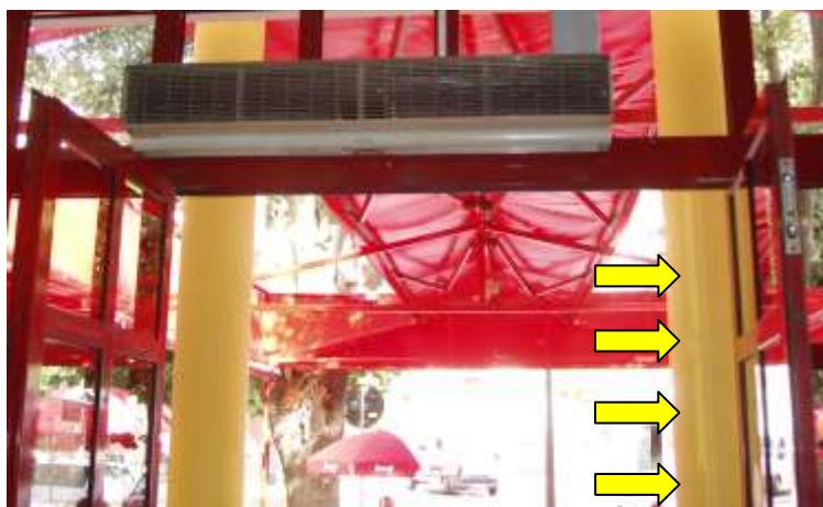
Fig. 11 – Exemplo de insuficiência do parâmetro geométrico relativo ao comprimento do bocal da cortina de ar.
