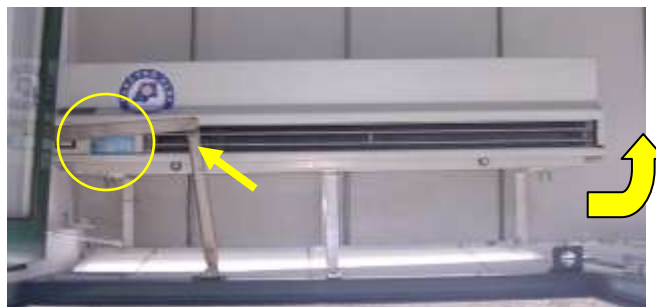
Fig.14 – Exemplo de uma situação em que são notórias as interferências e as fugas do jacto de ar.
