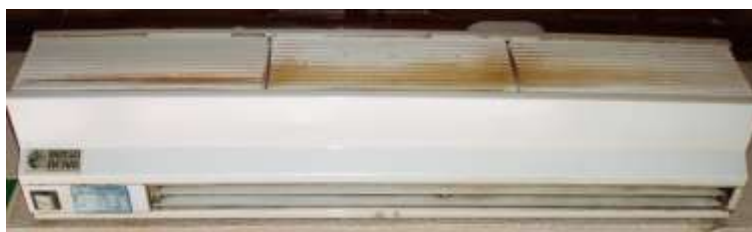
Fig.16 – Exemplo de um aparelho de cortina de ar a “funcionar” sob condições de nítida degradação.
