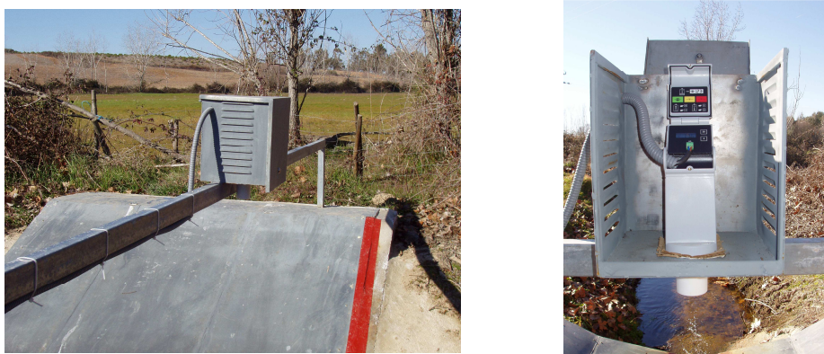
Figura 3.23 – Aspecto de la caja de protección de la sonda montada al centro de la sección de control del aforador.
