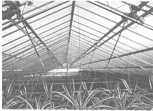
Figura 2.2 - Fotografia de estufa com comando eléctrico de aberturas zenitais.
