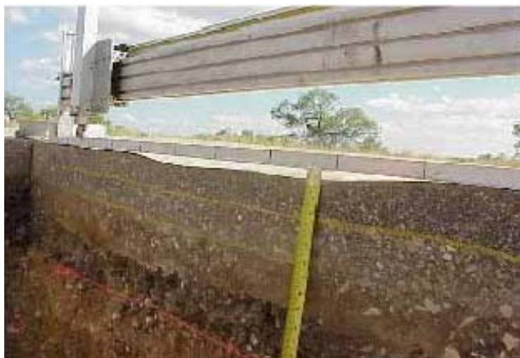
Figura 2.6 - Pavimento flexível com deformação ocorrida à superfície devido à deformação permanente das misturas betuminosas (NCHRP, 2002)
