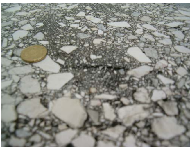
Figura 5.5 - Exemplo de segregação num provete de obra
