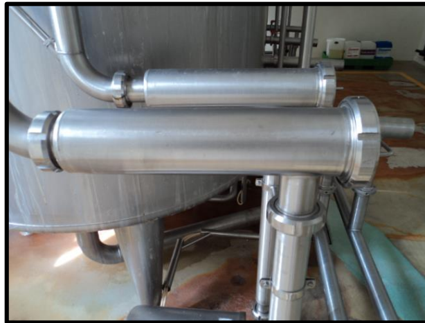
Figura 8-3 Filtros de CIP.
