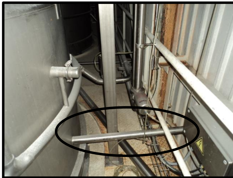
Figura 8-17 Instalação atual para descarga do Scrubber pelo Ciclone 2.
