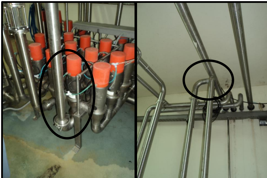
Figura 8-12 Fotografias de pormenores ao retorno de CIP da linha dos Coletores.
