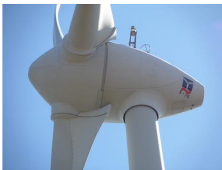
Figura 26 - Aerogerador Enercon E-70 E4 – 2MW (34)
