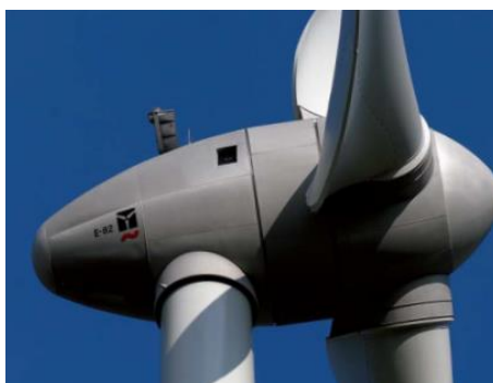
Figura 27 - Aerogerador Enercon E-82 E2 – 2,0MW (34)
