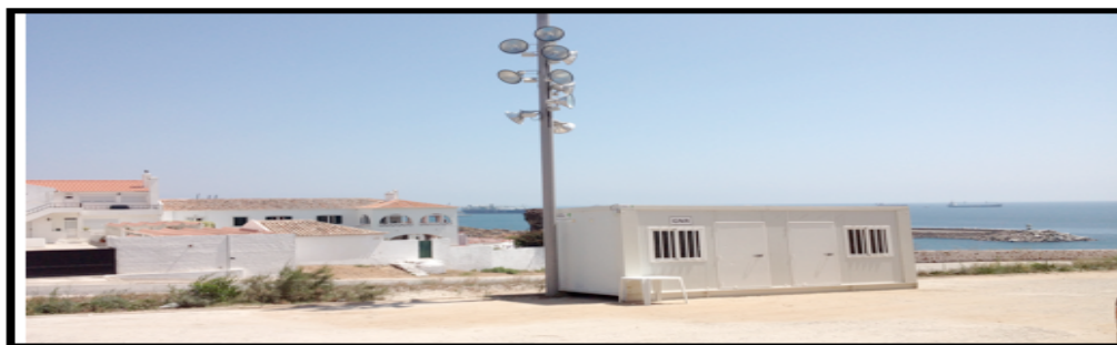
Figura 37 - Sistema de altifalantes instalado no posto improvisado da GNR
