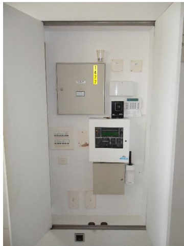
Figura 7- Vista geral do SADI
