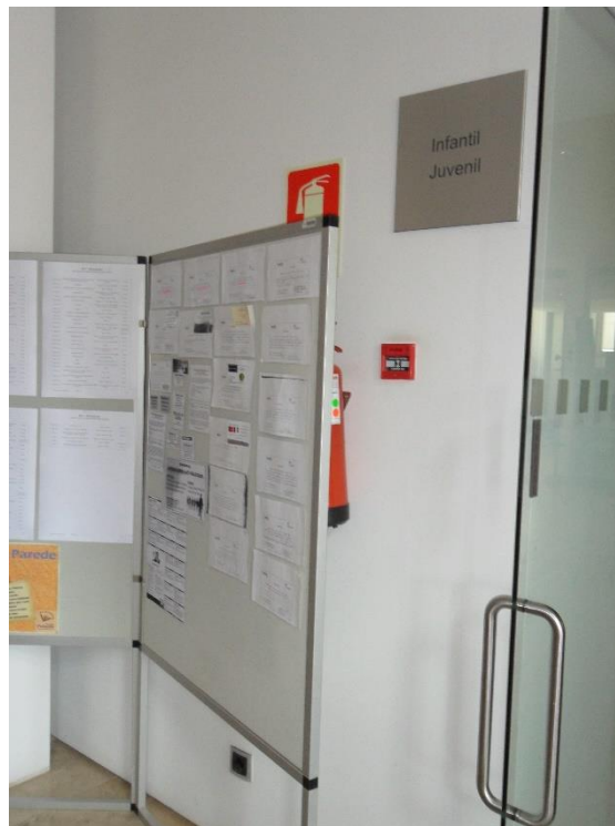
Figura 16- Extintores e botoneira tapados
