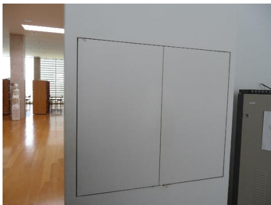
Figura 14- Quadro elétrico sem sinalização
