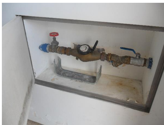
Figura 3- Corte geral de água
