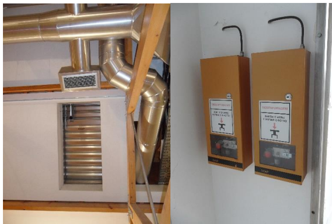
Figura 6- Pormenor da janela e do comando manual do sistema de desenfumagem
