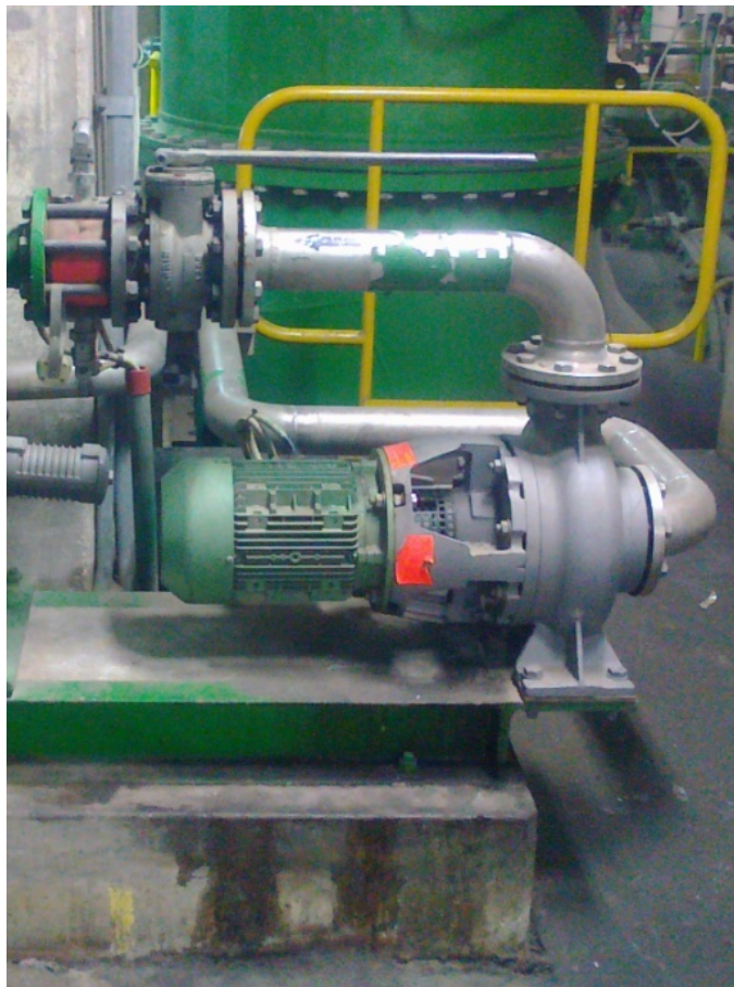
Figura 3.12 – Bomba de Recirculação de bolas. Fotografia tirada a 16-07-2013
