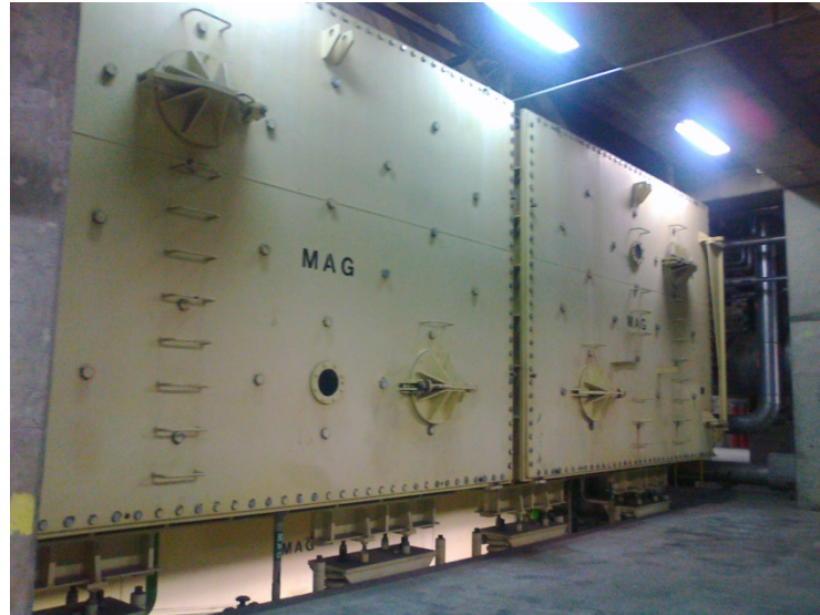
Figura 3.1 – Condensador do Grupo 1. Fotografia tirada a 14-03-2013
