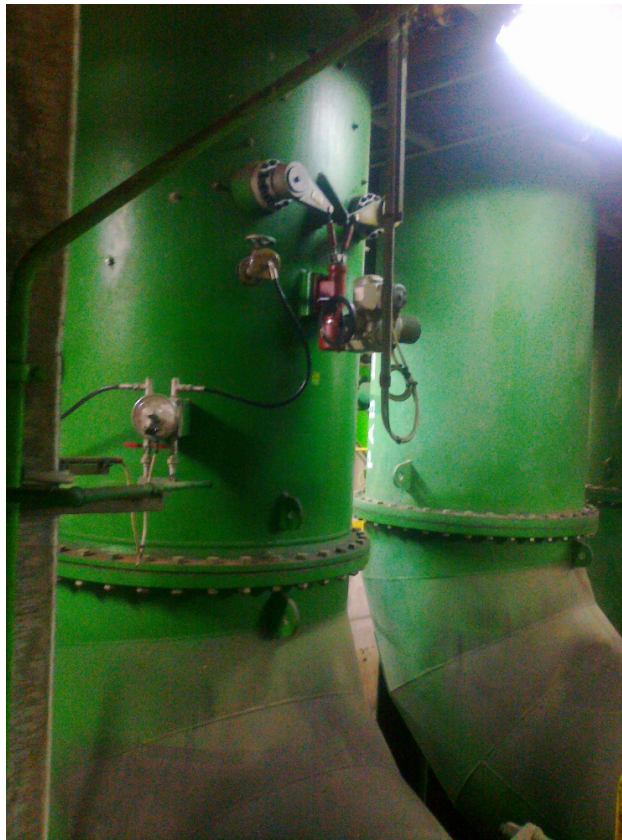
Figura 3.9 – Secção do filtro. Fotografia tirada em 16-07-2013
