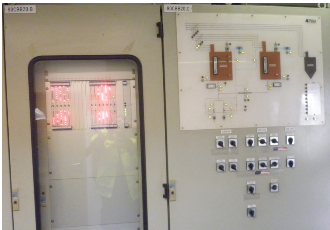
Figura 4.4 – Armário de controlo do silo principal 20
