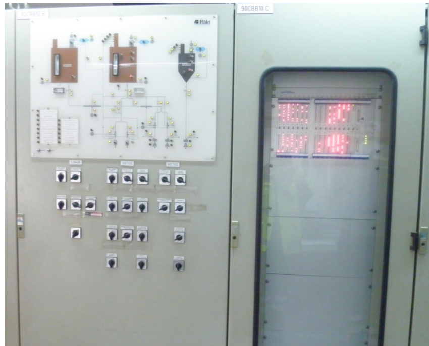
Figura 4.3 – Armário de controlo do silo principal 10 e silo de arranque 01
