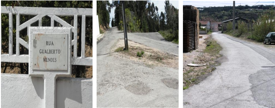
Figuras 183 – Identificação da rua, pavimento em mau estado.
