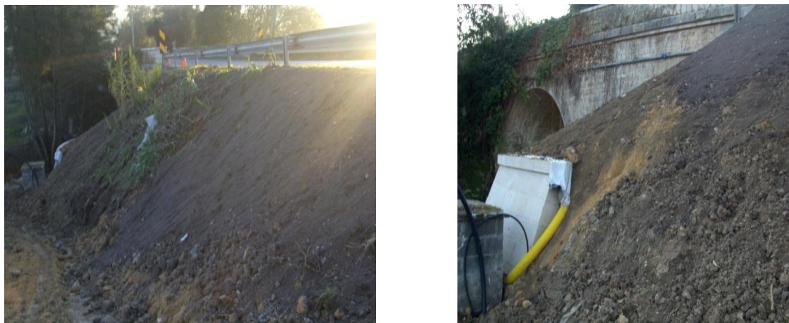
Figura 144 – Reposição do talude com terra vegetal e colocação de tubo geodreno com manta geotêxtil.
