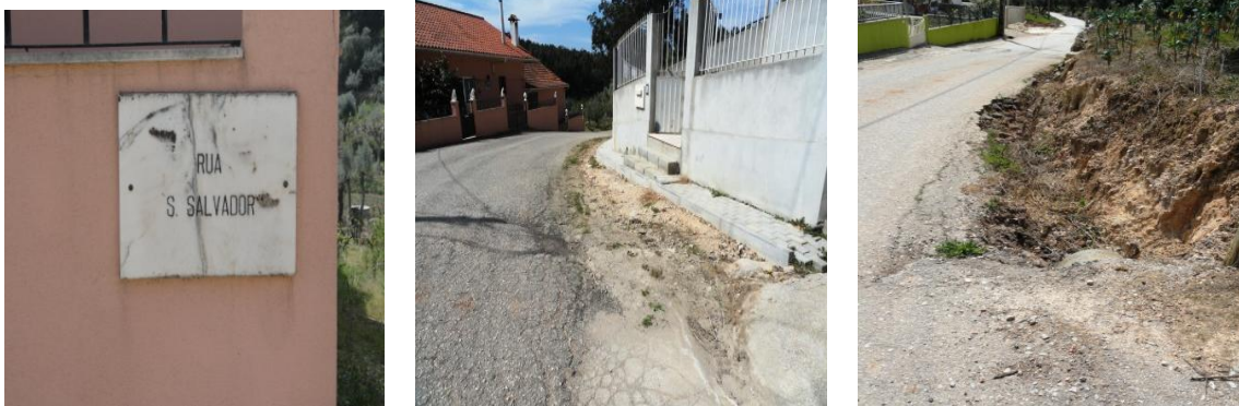
Figuras 168 – Estado do pavimento da rua S. Salvador em Toucinhos - Alburitel
