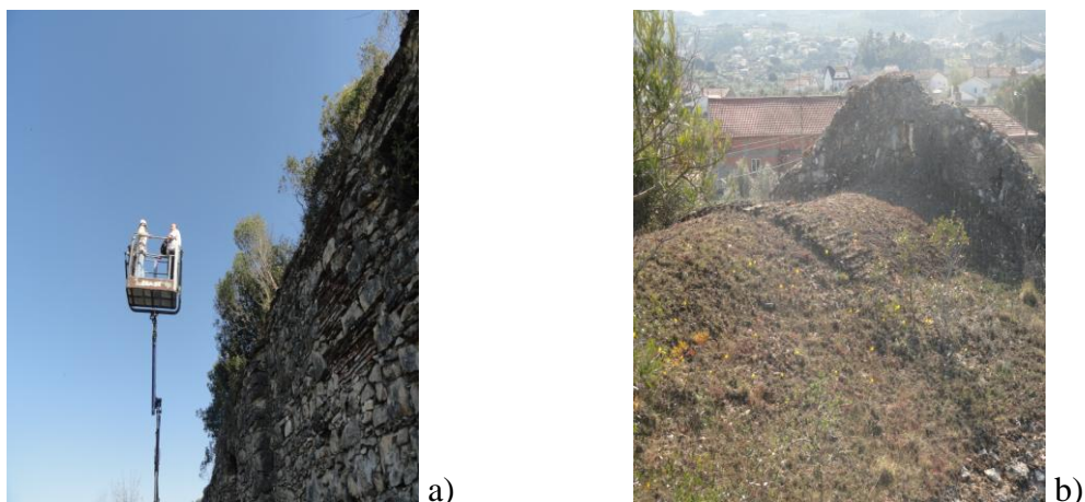
Figuras 15 a) – Meio de acesso à cobertura com plataforma elevatória; b) Aspeto geral das abóbadas.
