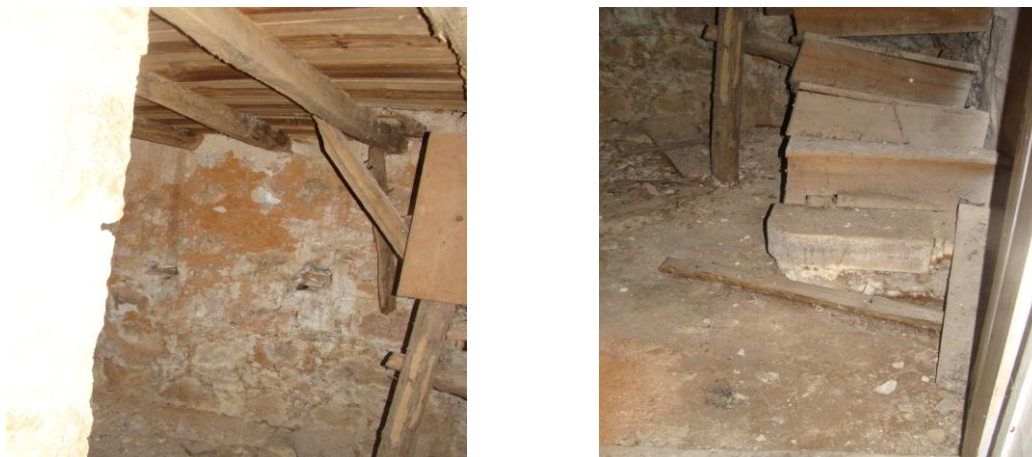
Figura 102 – Acesso á torre com madeira degradada.
