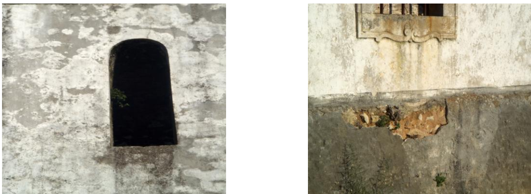
Figura 104 – Aspectos de desagregação dos revestimentos.
