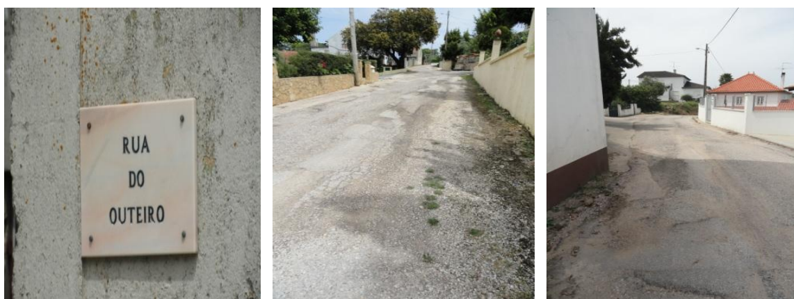
Figuras 192 – Rua do Outeiro com pavimento danificado
