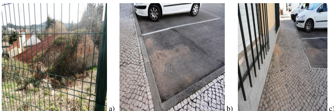
Figuras 158 – a) Vegetação na cobertura; b) Abatimento do pavimento betuminoso; c) Abatimento da calçada.
