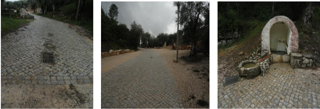
Figuras 173 – escoamento de águas no parque de merendas das Fontainhas da Serra - Atouguia
