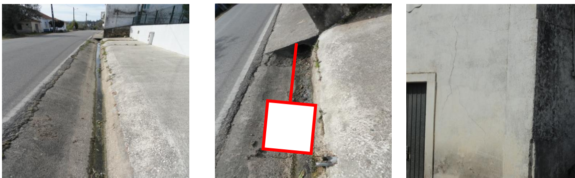
Figuras 171 – Rua Principal da Cavadinha com valeta pendente insuficiente e fissura na no cunhal.
