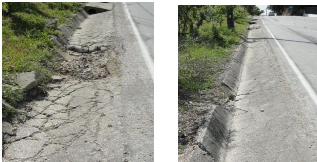
Figuras 186 – Valeta em betão com troços desagregado e fendilhados.
