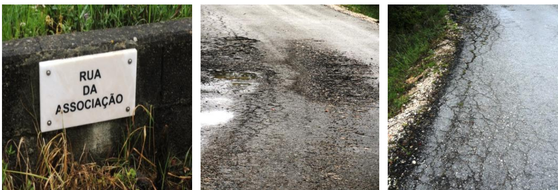
Figuras 178 – Identificação da rua e pavimento com deformação na camada inferior.
