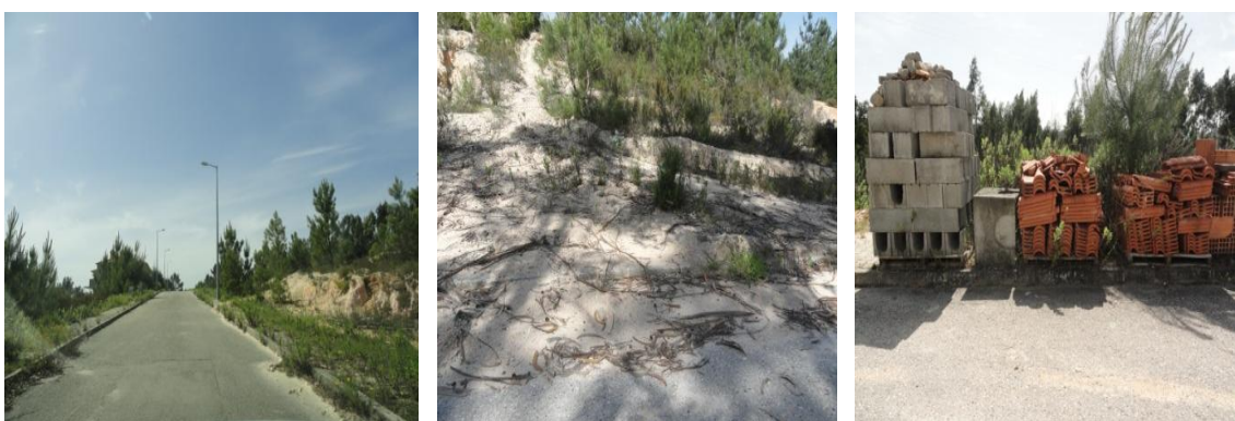
Figuras 188 - Urbanização D. Manuel II ao abandono, areias arrastados pelas águas e materiais de construção nos passeios.
