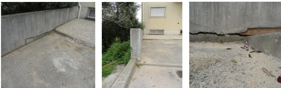
Figuras 182 – Vistas de muro com fissura.
