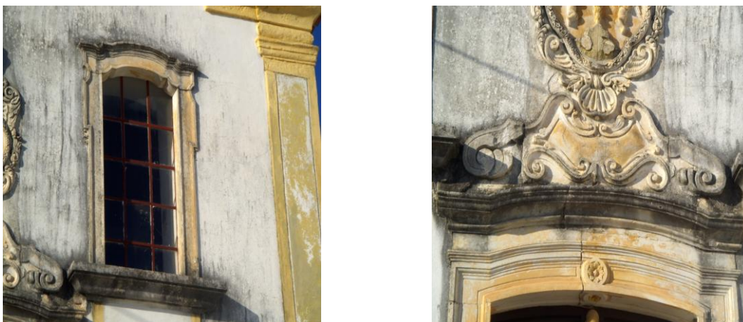
Figura 101 – Pedras calcárias, paramento com nódoas e verga com fissura.
