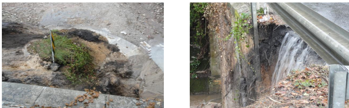
Figura 133 – Aspetos do escorregamento do talude.
