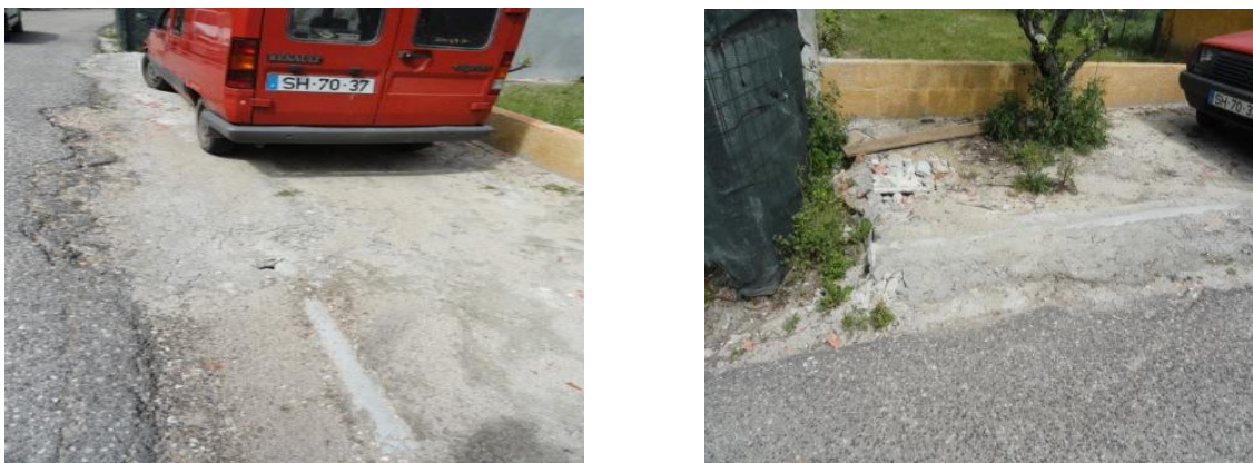
Figuras 181 – Passeio com manilhas à vista e pavimento danificado.
