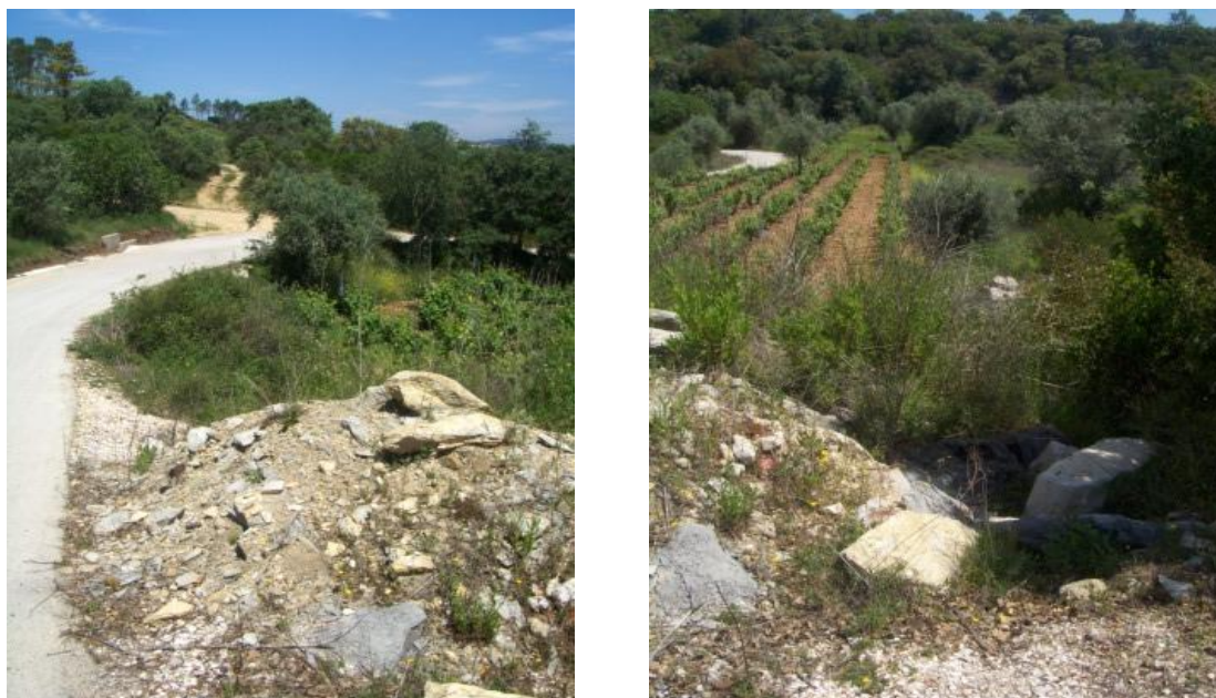
Figuras 187 - Localização do muro, pavimento com erosão da camada de base e enquadramento.
