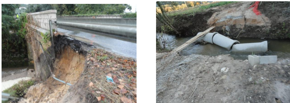
Figura 134 – Tubo de abastecimento de água com rotura e passagem entre margem interrompida.
