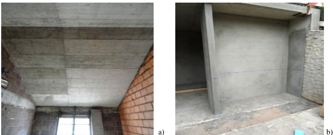
Figuras 68 – a) Execução de paredes em alvenaria de tijolo; b) Reboco da casa das máquinas.
