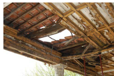
Figura 96 - Exemplo da degradação generalizada das estruturas
