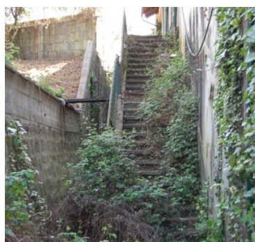
Figura 89 - Exemplo do estado de degradação das escadas (em ruínas)
