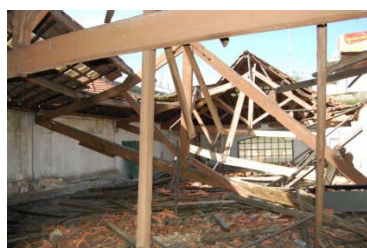
Figura 88 - Exemplo do avançado estado de degradação dos telhados
