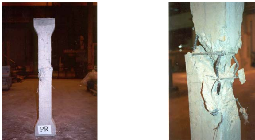
Figura 10 – Ruptura do pilar de referência (PR)
