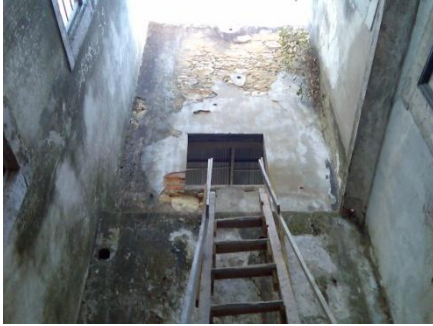
Figura 49 – Paredes exteriores com desagregação dos elementos constituintes.
