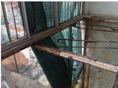
Figura 10 – Estrutura de tardoz de varanda com recurso ao ferro sem tratamento devido, passível de corrosão.
