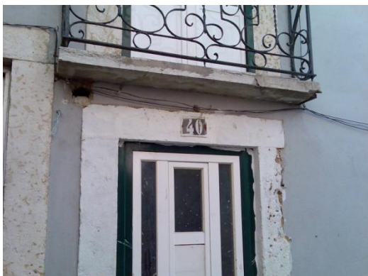
Figura 34 – Moldura efetuada em argamassa “imitando” cantarias de pedra, denunciando poupança no método construtivo.
