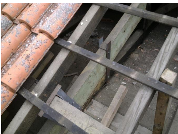
Figura 125 – Reforço de ligação entre a linha e a perna através de elementos metálicos.
