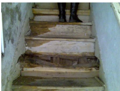
Figura 74 – Estrutura de escadas danificada, com colapso de um espelho e um cobertor.
