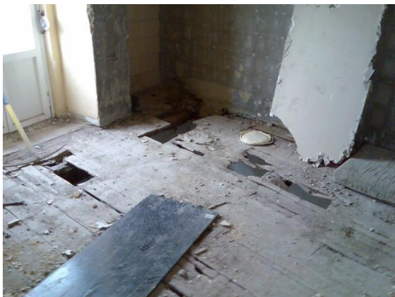
Figura 42 – Deterioração do pavimento de madeira devido a rutura do sistema de drenagem de águas residuais.
