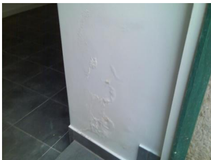
Figura 56 – Patologia em parede de alvenaria por presença de água por fenómeno de capilaridade.
