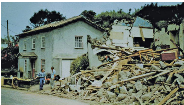
Figura 87 – Figura ilustrativa da diferença que pormenores de reforço estrutural podem fazer durante um sismo [Costa, A.; 2008].
