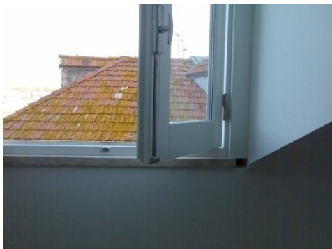
Figura 79 – Peitoril com comprimento insuficiente que deu origem a infiltrações de água.
