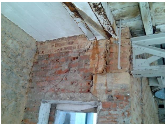
Figura 50 – Esmagamento e deformação de parede de alvenaria de tijolo por colocação de vigas metálicas apresentando ainda estas corrosões visíveis.
