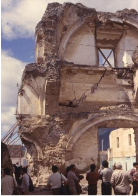
Figura 2 – Danos devido ao sismo de Nicarágua na Catedral de Antígua, em 1972 [Oliveira, C.; 2008].
