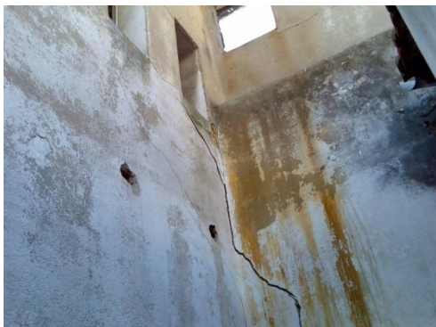
Figura 46 – Fenda entre paredes convergentes.
