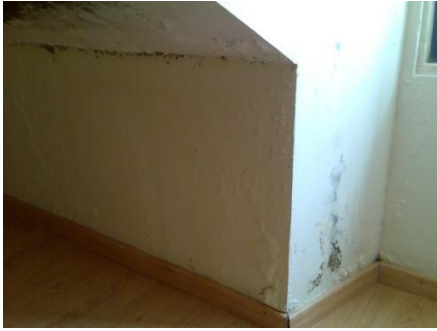
Figura 71 – Infiltração numa caleira obstruída de uma platibanda que originou uma infiltração para o interior do último piso do edifício em questão.
