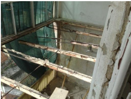
Figura 66 – Perfis metálicos corroídos com redução substancial de secção e rotura de ligações.
