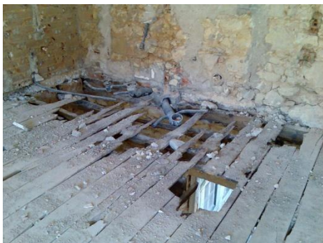
Figura 111 – Pavimento degradado na zona de entrega das vigas de madeira e em boas condições nas restantes secções.
