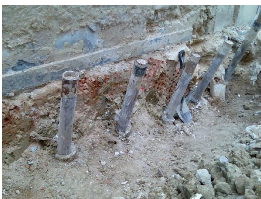
Figura 44 – Escavação junto a fundações em arco de alvenaria de tijolo deixando a descoberto a mesma e podendo originar assentamento.
