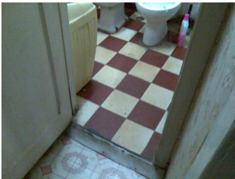
Figura 62 – Zona de instalação sanitária onde é visível a betonagem devido à diferença de cotas.
