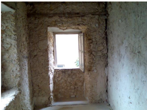
Figura 17 – Deslocamento de parede para fora do plano.
