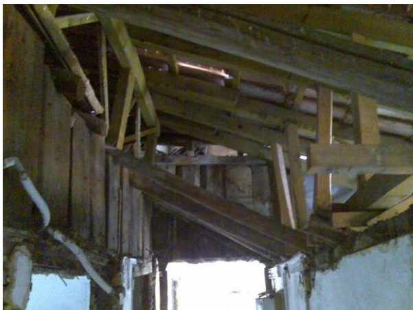
Figura 63 – É visível a estrutura antiga e estrutura mais recente da cobertura, com o aumento de um piso nas águas furtadas.
