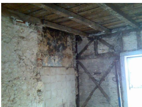
Figura 54 – Estrutura de madeira embutida numa parede exterior com patologias devido à presença de água.
