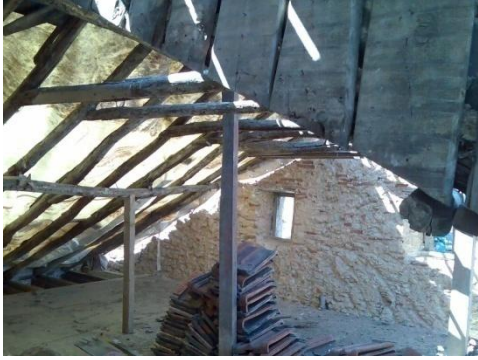
Figura 57 – Vigas de uma cobertura com deformações acentuadas por fluência.
