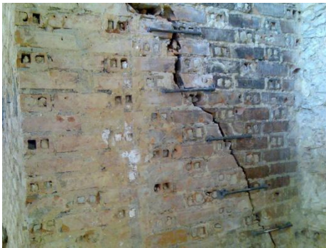
Figura 45 – Fenda em parede de alvenaria de tijolo devido ao assentamento da fundação.
