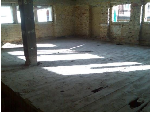
Figura 61 – Deformação acentuada do pavimento a meio vão.
