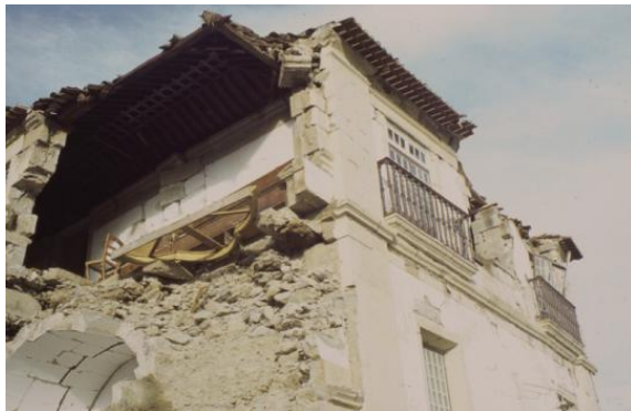
Figura 3 – Colapso parcial dos arcos de apoio da cobertura da sacristia de Sé de Angra do Heroísmo em 1980 [Oliveira, C.; 2008].
