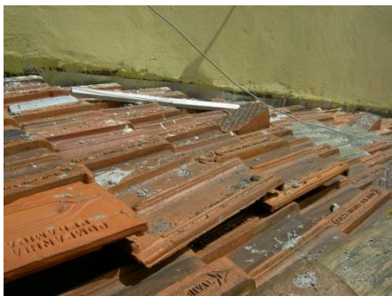
Figura 70 – Telhas desencaixadas com conseqüente infiltração de água devido a cedência da estrutura do telhado.
