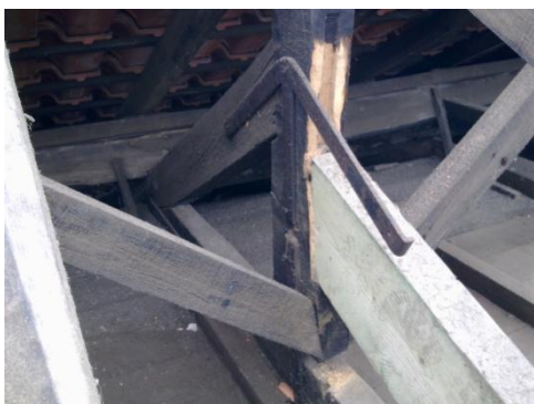
Figura 127 – Falta de simetria na estrutura das asnas, nomeadamente nas pernas e deficiente ligação metálica do “pé de galinha”.
