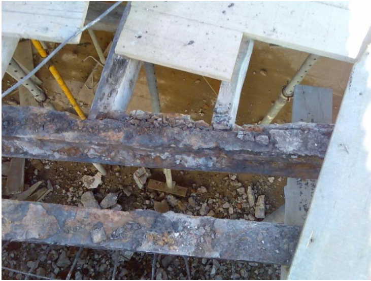
Figura 65 – Perfis metálico corroídos com redução da sua secção.
