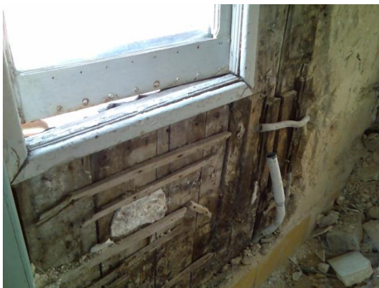
Figura 14 – Alteração estrutural devido à introdução de redes de saneamento.
