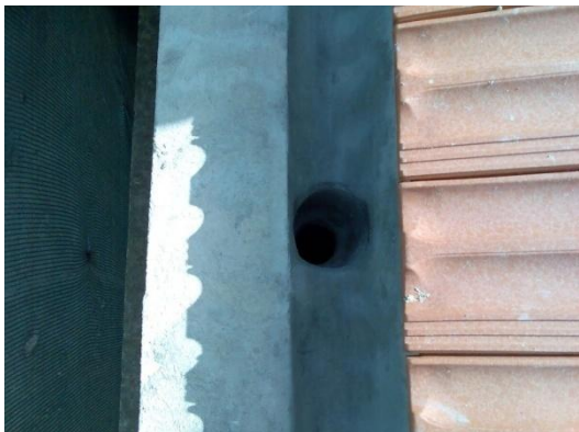
Figura 130 – Tubo de queda de algeroz para o exterior do edifício.
