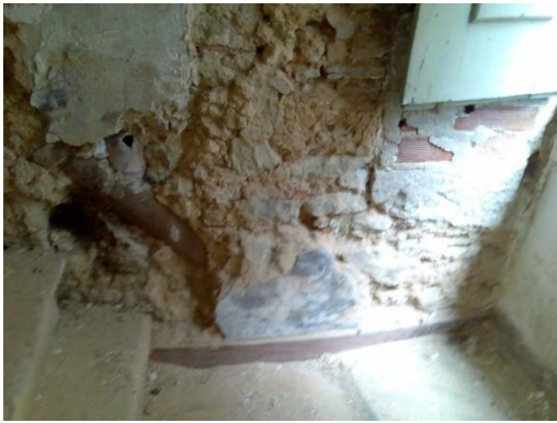
Figura 55 – Tubagem de grés danificada com rotura e fuga de águas.
