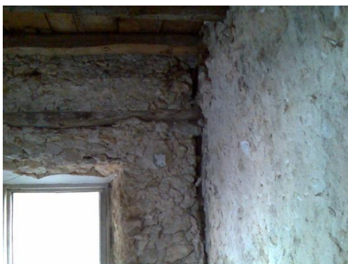
Figura 47 – Abertura de fenda considerável entre paredes convergentes devido a deslocamento de uma das paredes.
