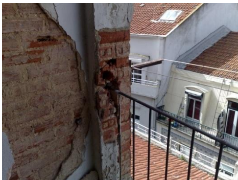
Figura 67 – Deterioração de parede devido à oxidação do elemento metálico.
