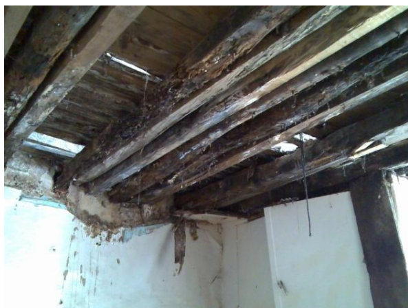
Figura 64 – Nesta figura é possível verificar, no mesmo edifício, a colocação de novo vigamento de modo a compensar a deformação devido ao aumento da carga.
