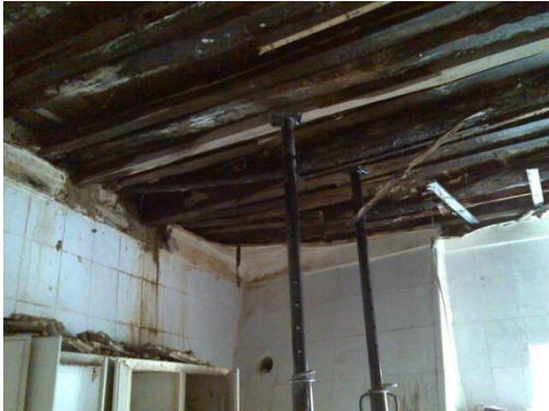
Figura 60 – Deterioração progressiva das vigas de madeira.
