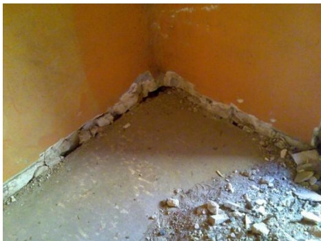
Figura 109 – Zona de entrega do pavimento degradada devido à cedência do frechal.
