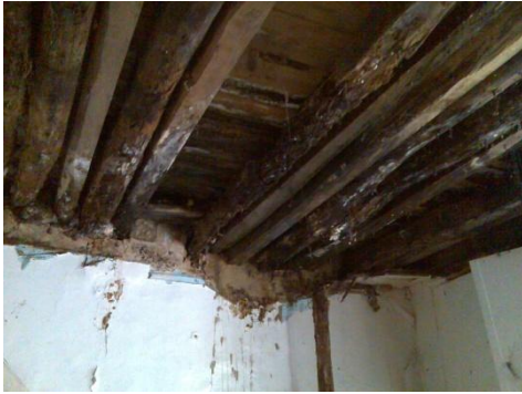
Figura 59 – Pavimento degradado devido a infiltração na zona de entrega dos vigamentos de madeira.
