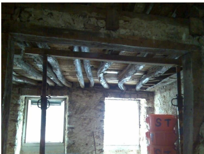
Figura 6 – Vigamento deformado e seccionado em parede intermédia em vez de corrido em todo o comprimento do edifício.
