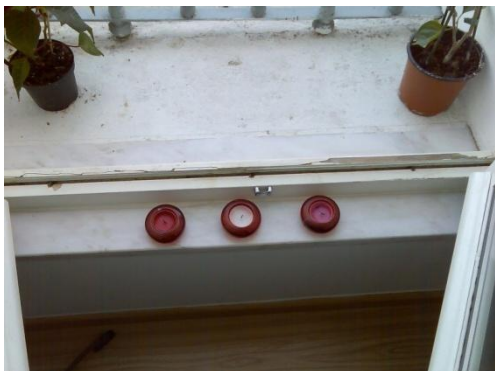
Figura 76 – Degradação dos caixilhos de madeira por falta de tratamento dos mesmos.
