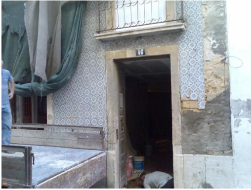
Figura 51 – Azulejos em queda devido ao mau estado da camada de base.
