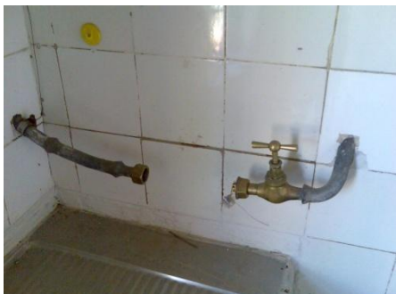
Figura 82 – Rede de abastecimento de água antiga.
