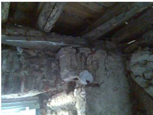
Figura 53 – Degradação dos arcos de tijolo na zona da verga de um vão de janela.
