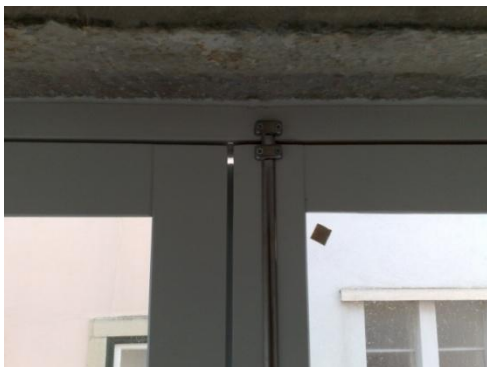
Figura 78 – Novo vão de janela de madeira aplicado com “folga” acima do aceitável.
