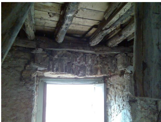
Figura 32 – Arcos de descarga na padieira de um vão de janela com deformação acentuada.
