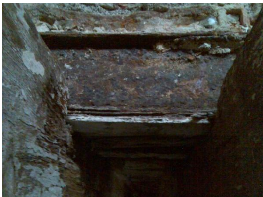
Figura 124 – Perfil metálico completamente deteriorado. É notório a redução de secção, com banzos a desaparecer. Neste caso é necessário a substituição integral do perfil.
