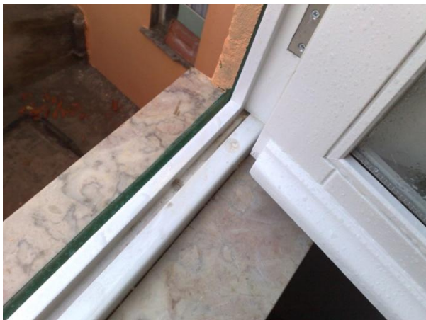
Figura 77 – Infiltração de água para o interior da habitação por insuficiente escoamento de água do caixilho.
