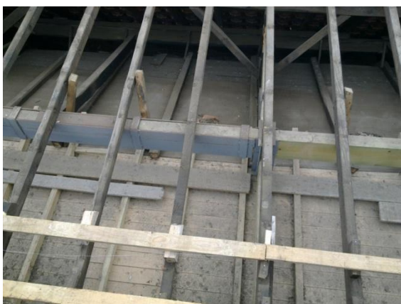
Figura 40 – Reparação de um vigamento de madeira através de um empalme efetuado entre uma viga existente e uma nova, reforçado com elemento metálico com proteção contra a corrosão.
