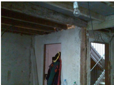
Figura 73 – Estrutura da caixa de escada a servir de apoio às vigas de pavimento.
