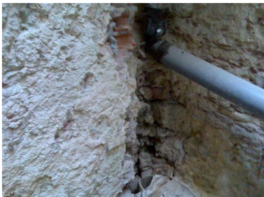
Figura 80 – Rede de saneamento de águas residuais para um saguão onde é visível o grés no chão partido, provocando infiltração no piso da cave do edifício.
