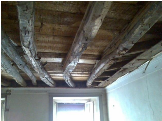
Figura 18 – Vigas de pavimento de secção circular, indicando falta de tratamento antes da aplicação.
