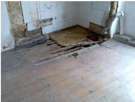
Figura 58 – Deterioração de pavimento devido a rutura da rede de águas residuais domésticas.
