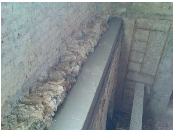
Figura 91 – Regularização de apoio para vigamento de madeira de acordo com o esquema da figura 92.
