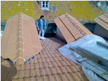
Figura 72 – Toda a cobertura deve ser alvo de inspeção detalhada de modo a averiguar futuras patologias.
