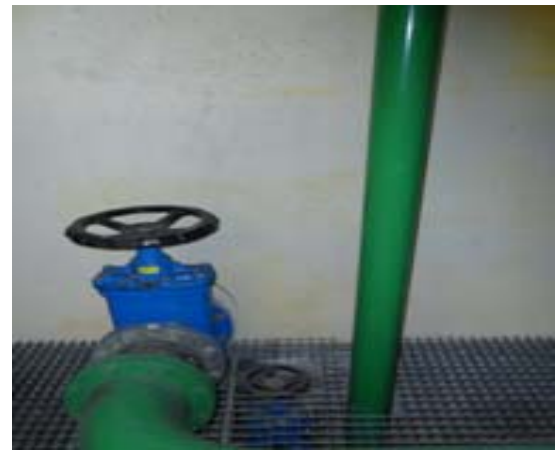
Válvulas de corte do abastecimento ao reservatório
