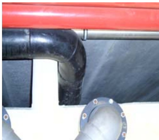
Ligação ao reservatório
