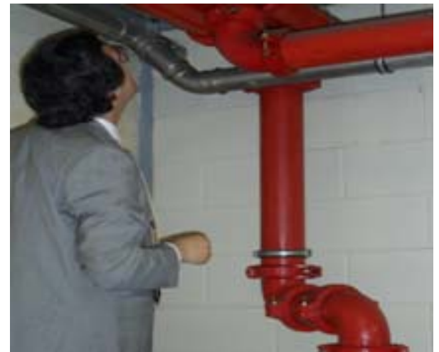
Tubagem de rede de incêndio
