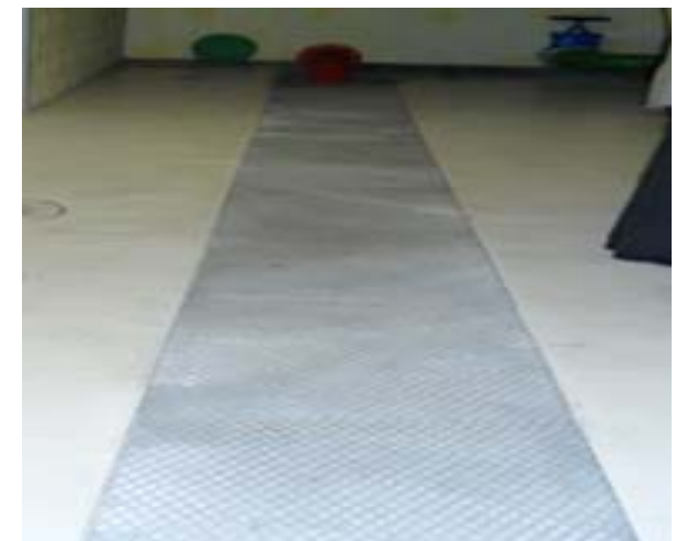
Caleira de ligação entre reservatórios
