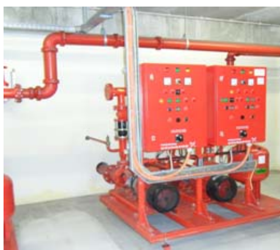
Central de incêndio
