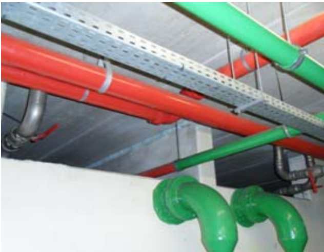
Entrada do reservatório de duplo armazenamento
