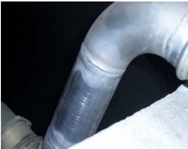
Tubagem de entrada no reservatório
