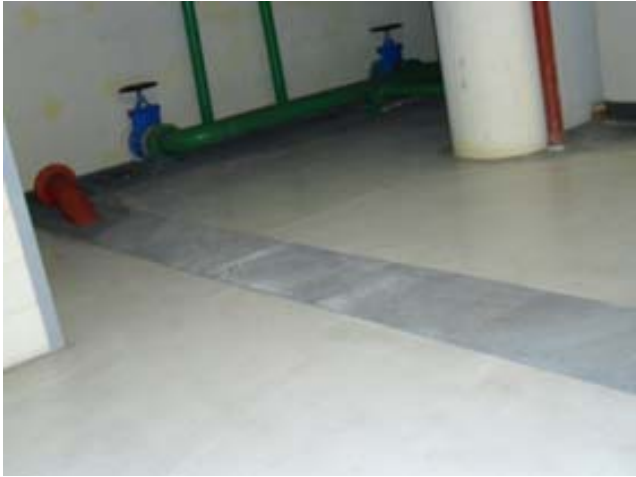
Caleira de ligação entre reservatórios
