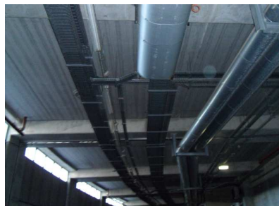
Imagem IV.31 - Tubagens e acessórios de ligação ao piso 0
