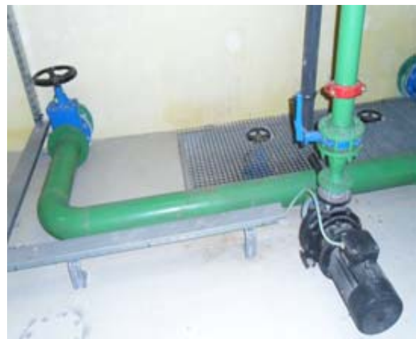
Vista para acesso ao reservatório ativo à rede de incêndio
