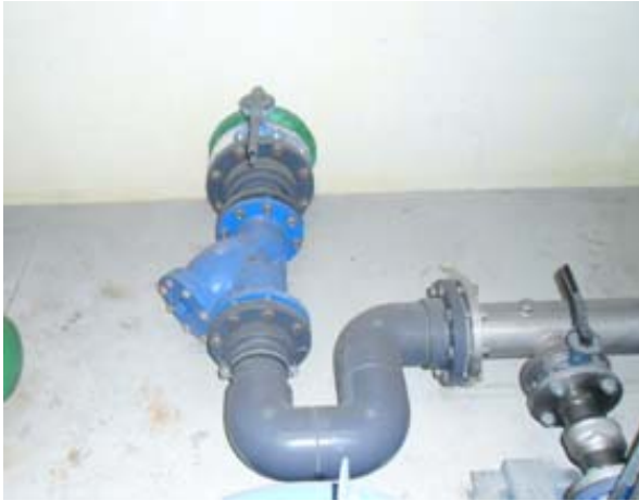
Rede de drenagem
