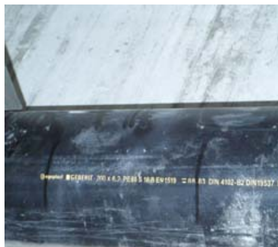
Pormenor da tubagem, Geberit
