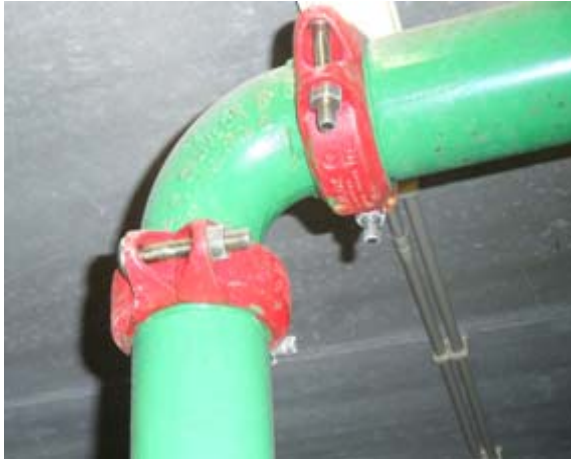
Tubagem da rede de incêndio
