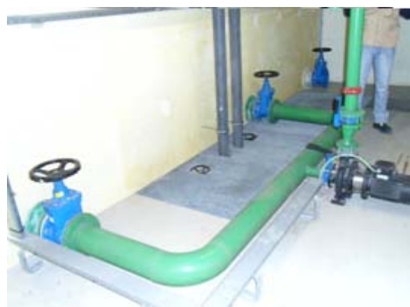
Vista para acesso ao reservatório ativo à rede de incêndio
