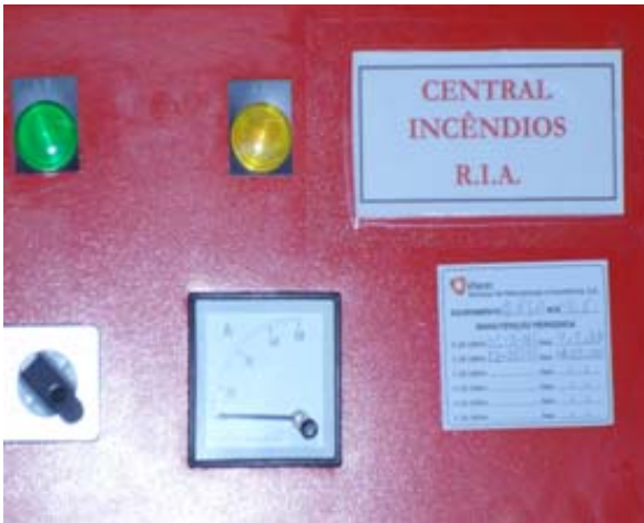
Central de incêndios, R.I.A
