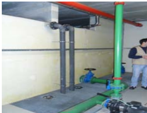
Vista para acesso ao reservatório ativo à rede de incêndio
