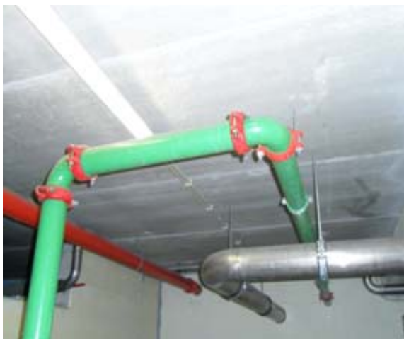
Tubagem de rede de incêndio
