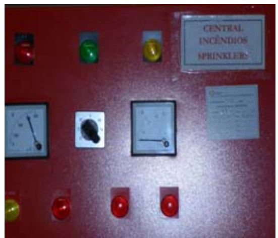
Central de incêndios, sprinklers
