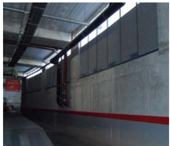
Caminho das tubagens, cave 1
