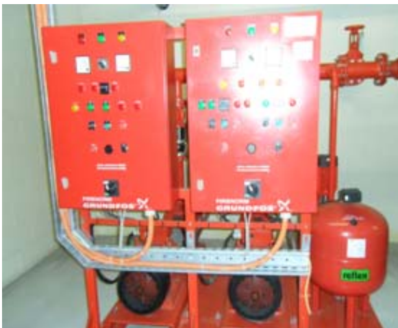
Central de incêndios
