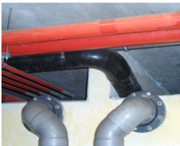
Ligação ao reservatório
