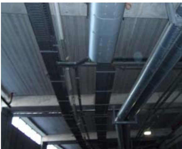
Caminho das tubagens, cave 2
