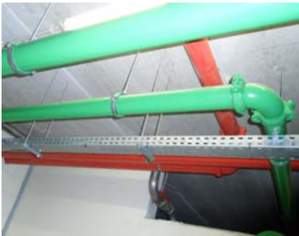
Tubagem de abastecimento da rede
