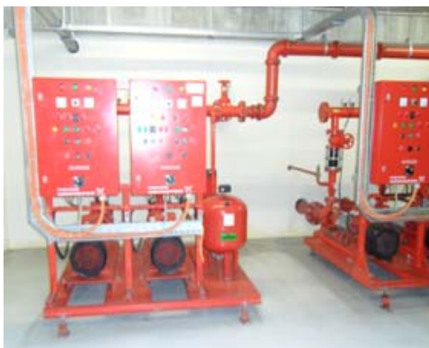
Central de incêndio
