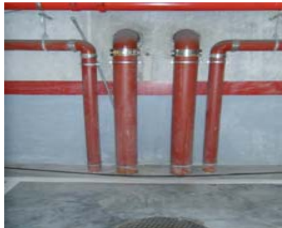
Tubagens de drenagem da rede
