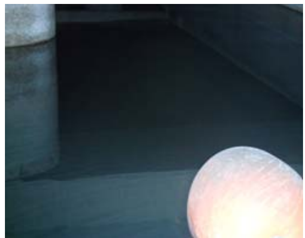
Boia de controlo do nível de água no reservatório
