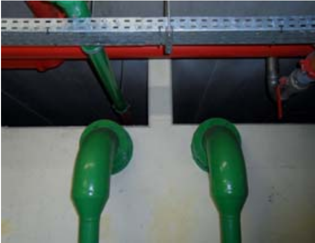
Entrada do reservatório de duplo armazenamento
