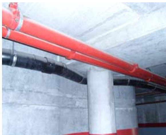
Encaminhamento das águas dos pilares para o reservatório
