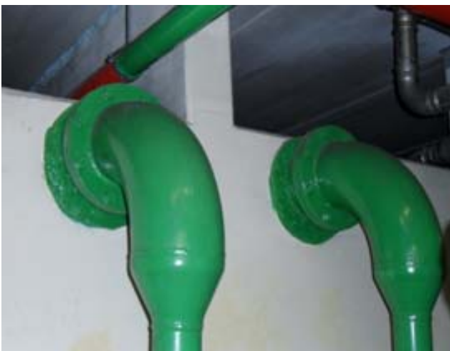
Pormenor de tubagem de descarga do reservatório
