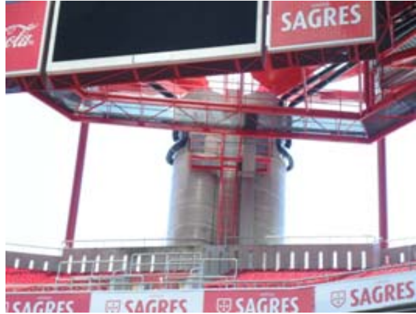
Pilares com ligação das tubagens à cobertura
