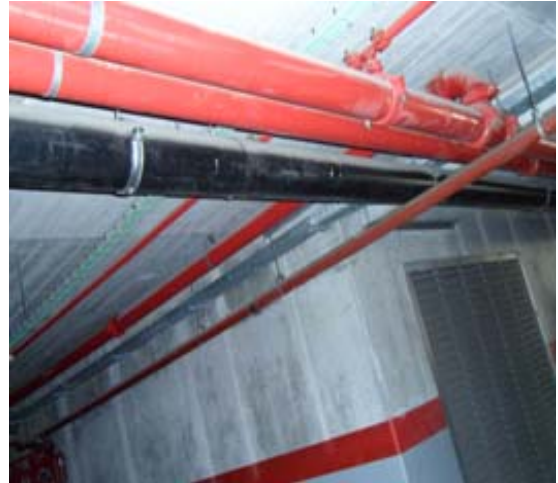
Encaminhamento das águas para o reservatório
