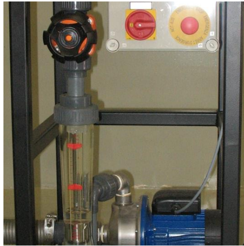
Figura 46 - Quadro elétrico, válvula de regulação de caudal e bomba centrífuga.
