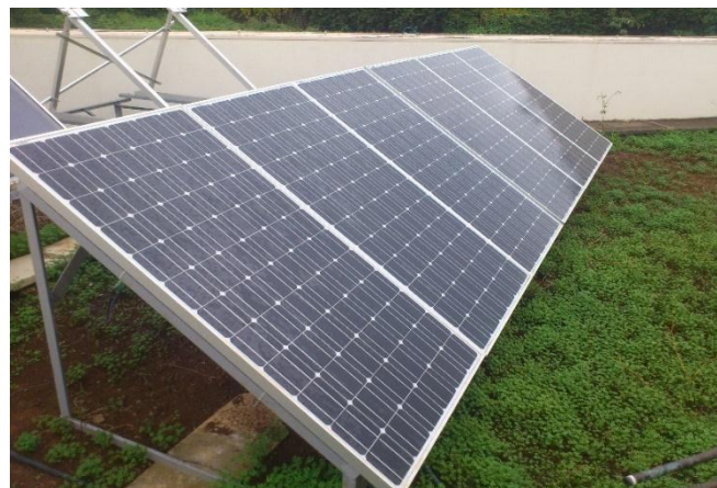
Figura 3.3 – Painéis PAIRAN EGM-185 instalados na Universidade da Madeira.
