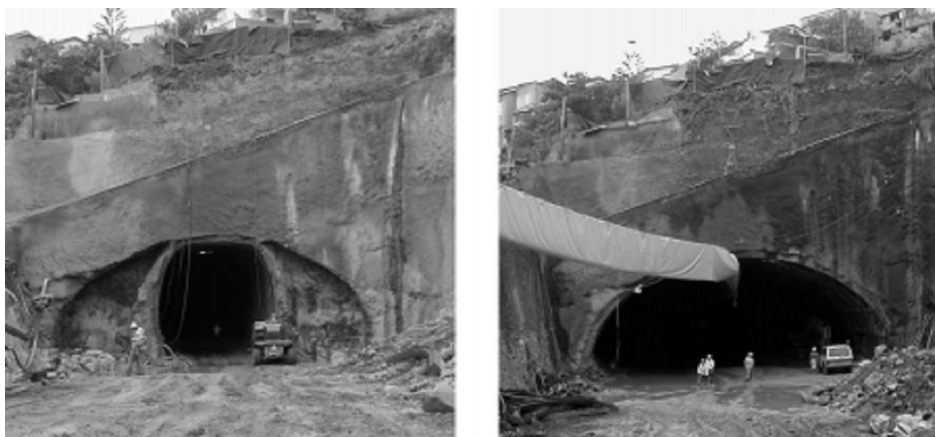
Figura 5.60: Escavação segundo a filosofia NATM (túnel piloto e alargamento da meia secção superior) no emboquilhamento Leste do túnel de S. Cruz Oeste (adaptado de BRITO et al , 2000).
