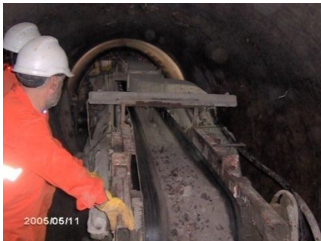
Figura 8.3: Sistema de extracção da tuneladora usada no túnel do Covão.
