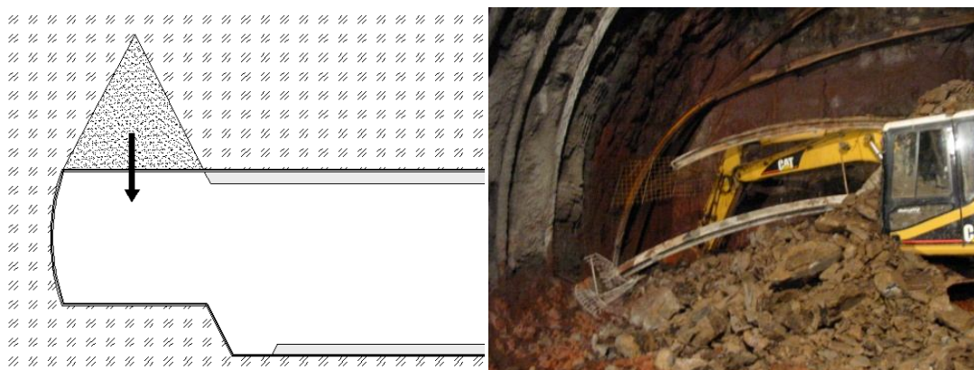
Figura 3.6: Desabamento do topo do túnel.
