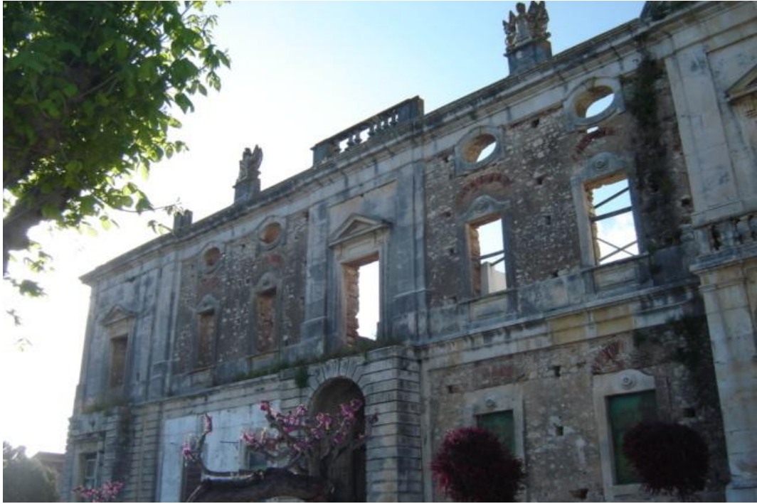
Estado de degradação da fachada principal do palácio
