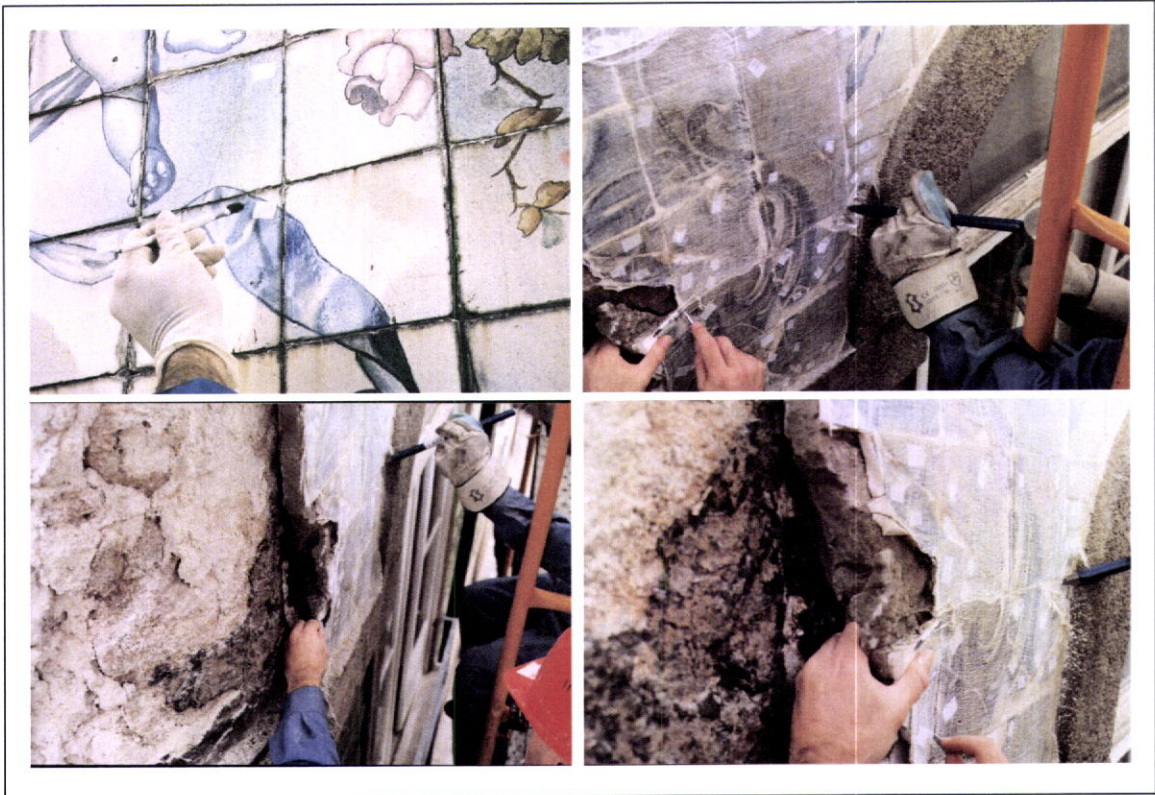
Fig. 5_161 – Etiquetagem de todo o painel a ser retirado, seguindo os critérios convencionais. Uso de etiquetas adesivas com tinta insolúvel em água. Após a etiquetagem colocação de uma gaze hidrófila e espalhada com uma trincha uma solução líquida de Paraloid B72 diluído em 15% acetona em forma de cruz.
