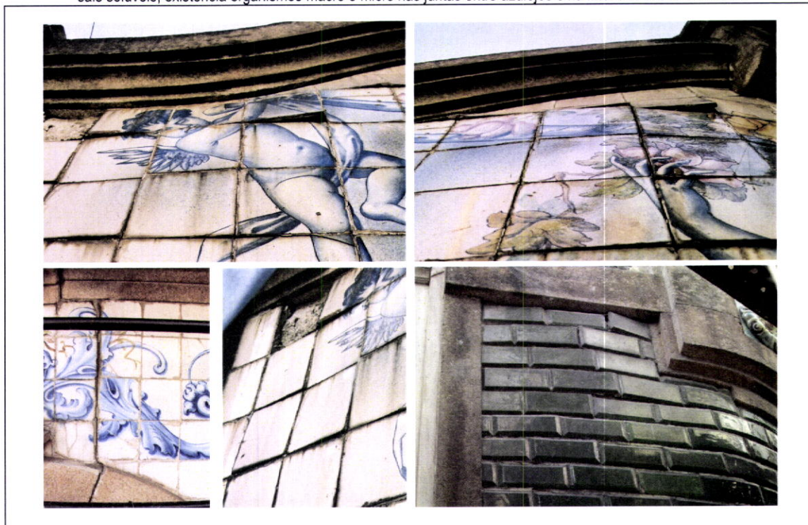
Fig. 5_145, Fig. 5_146, Fig.5_147, Fig.5_148 e Fig.5_149 – Levantamento fotográfico pormenorizado do estado de conservação do revestimento de fachada a azulejo, do edifício, após montagem dos andaimes. Registo dos problemas mais graves de deterioração do painel inerentes ao suporte arquitectónico: término da vida útil das argamassas de assentamento e instabilidade do suporte arquitectónico (fracturas visíveis no gaveto e na padieira dos vãos), existindo azulejos em falta, muitos azulejos fendilhados e a destacarem-se do seu suporte ou em queda eminente.
