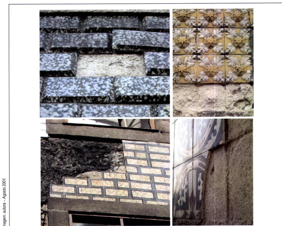
Fig.4_57 – Azulejo biselado em queda eminente. Descolamento do azulejo do seu suporte. Rua da Alegria.
