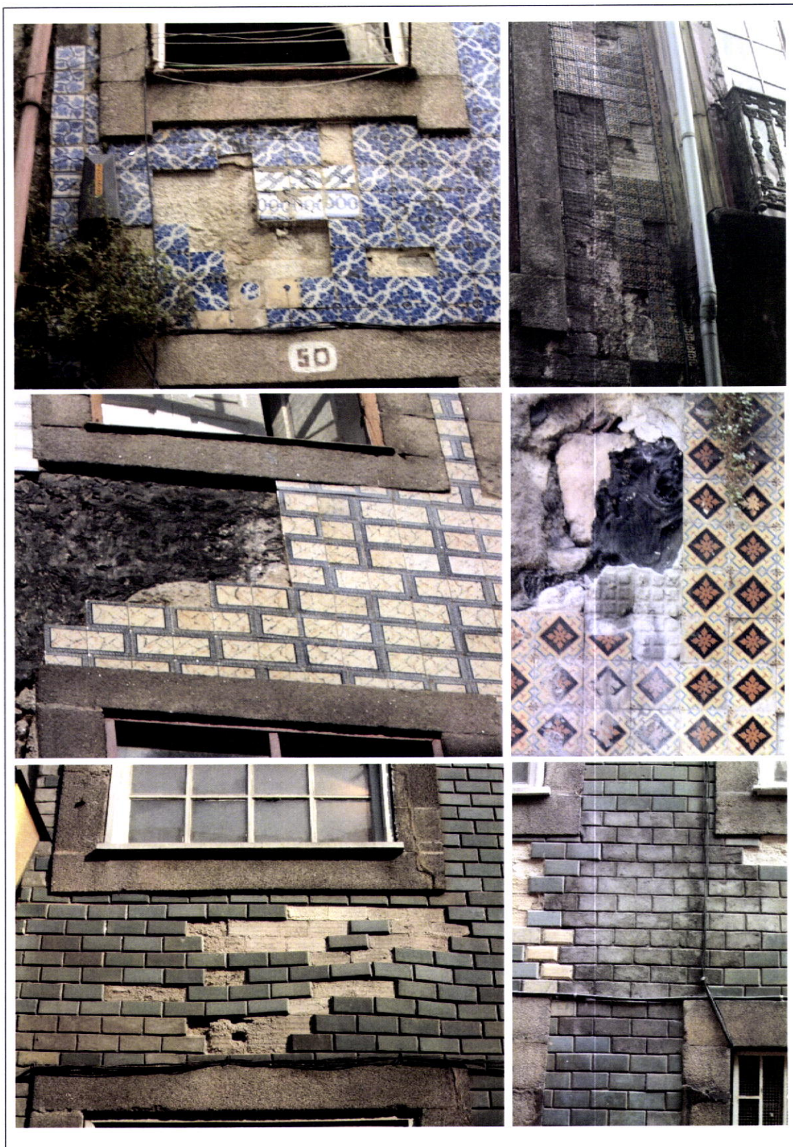
Fig.4_24 – Imagens do Porto (área em estudo) onde é visível o destacamento do reboco e das argamassas de assentamento do suporte, com destacamentos dos azulejos em bloco.
