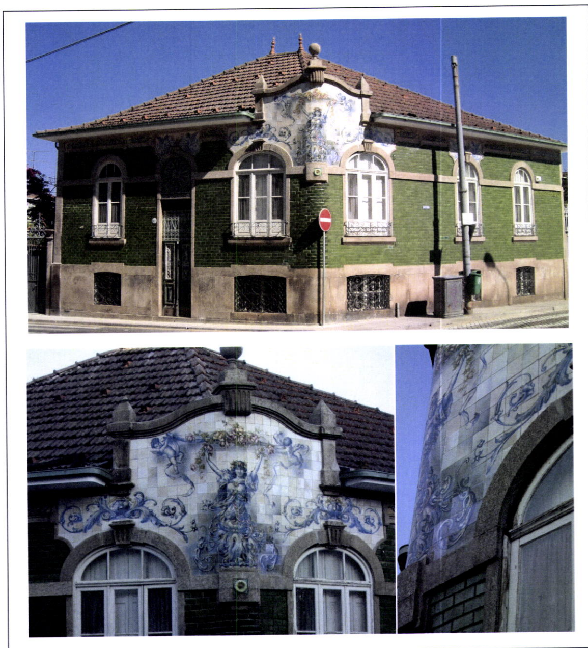
Fig. 5_247 – Casa em S. Roque da Lameira, Porto, final da obra. Vista geral e pormenor do painel recuperado.
