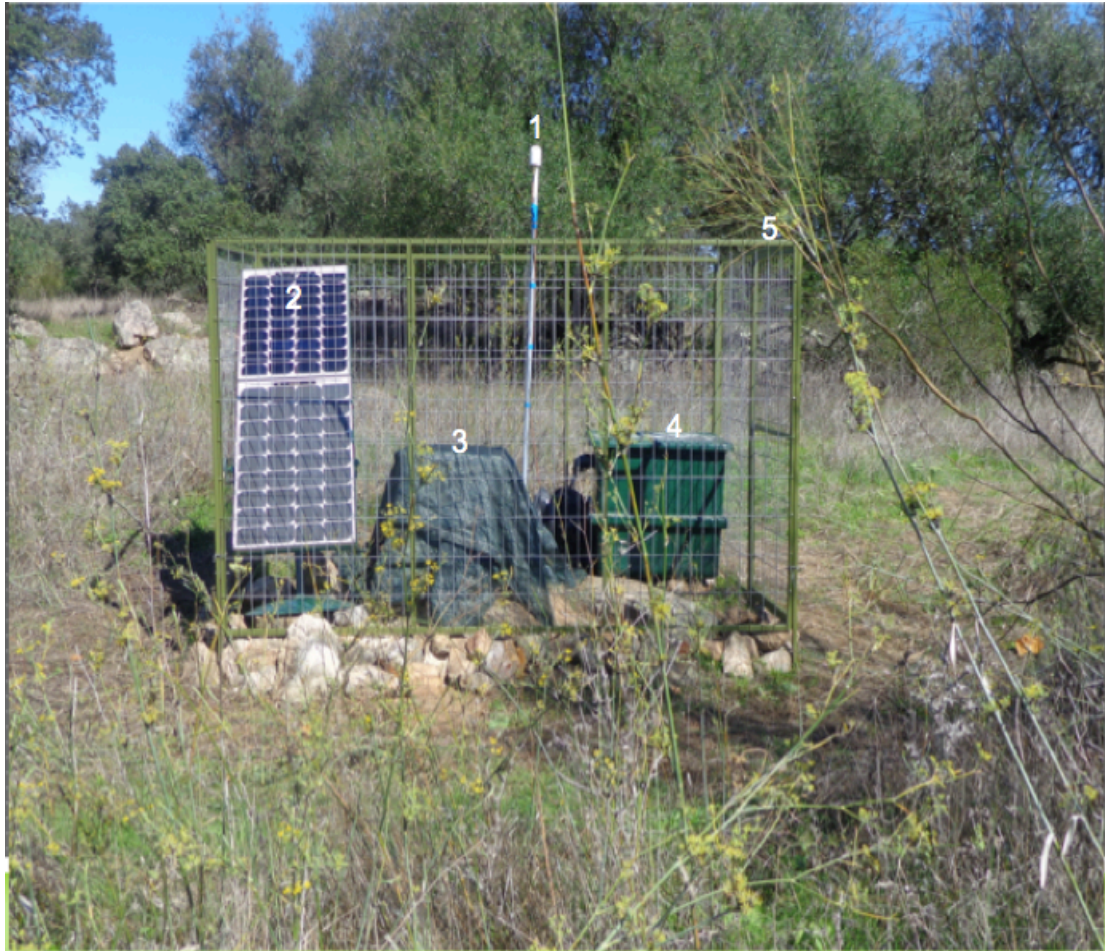
Figura 3.13- Estação ASER (Aldeia da Serra) localizada a 38^{\circ}47.80'N e 07^{\circ}58.15'W . Legenda: 1- GPS; 2- Painéis solares de 135 Ah (mais tarde substituídos por painéis solares de 130 W, ver a figura B.2 em apêndice); 3- Local de instalação do Sismómetro de Banda larga CMG 3 ESP (60s): assente sobre o afloramento rochoso granítico e protegido por uma manta térmica e por uma caixa isoladora, garantindo bom isolamento térmico e evitado desta forma a flutuações térmicas diárias. 4- Caixa protetora dos equipamentos: Computador de campo SeisComp Alpha 2000, Digitalizador CMG-D24-2000; Baterias de chumbo de 135 Ah e o aparelho de comunicação TELTONIKA HSPA + Router 7-30 VDC para comunicações GSM; 5- Vedação da estação.
