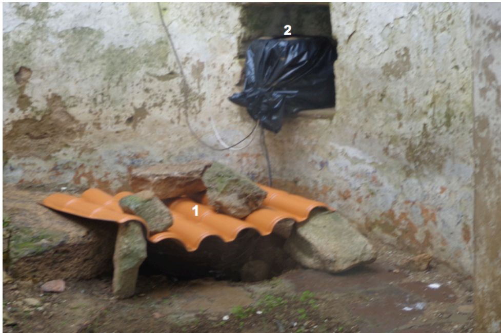
Figura 3.17- Interior do abrigo da estação CARR. Legenda: 1- Local de instalação do Sismómetro de Banda larga GURALP CMG 6TD (30s) enterrado sobre afloramento rochoso granítico e protegido por uma manta térmica e por uma caixa isoladora, garantindo um bom isolamento térmico que protege desta forma, o sismómetro das flutuações térmicas diárias; 2- Caixa protetora das baterias de 12 V (44 Ah/440 A-EN), dos cabos e do Breakout box CMG 6TD.
