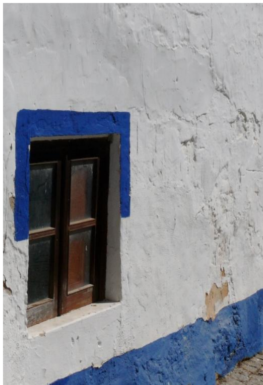
Fotografia 59 – Detalhe paredes caídas de um edifício no centro da vila de Odeceixe, 28.09.2012.
