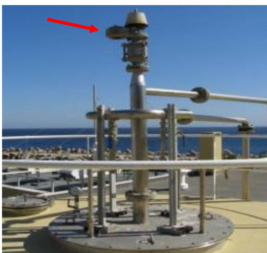
Figura 39 - Rede de injeção de biogás e válvula de pressão.
