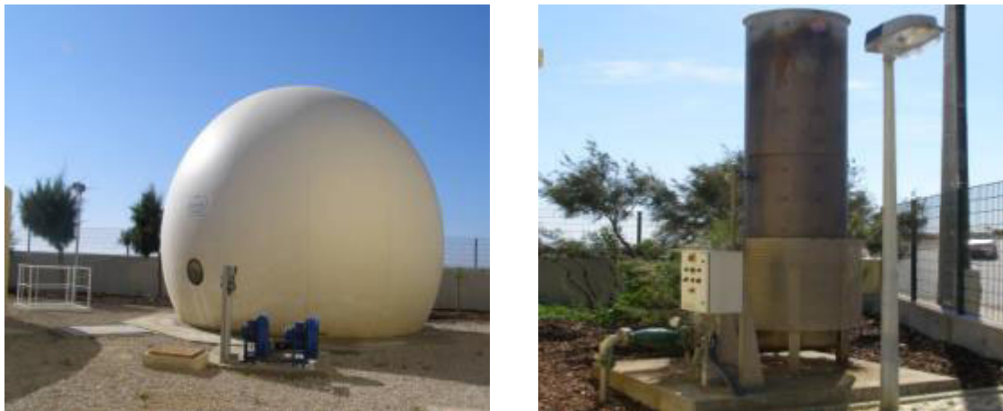
Figura 34 - Gasómetro e tocha instalados na ETAR de Sesimbra.
