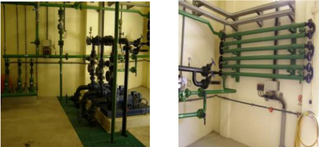
Figura 32 – Sala de aquecimento e permutador de calor
