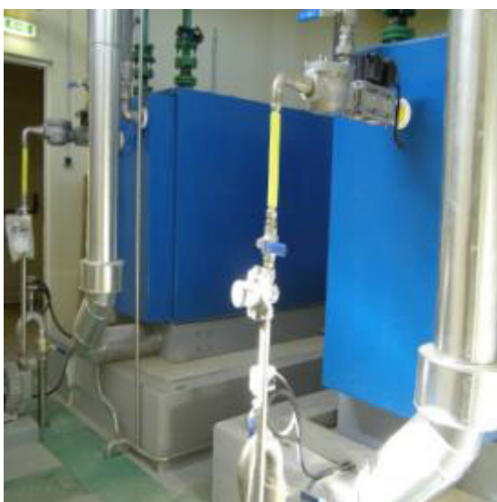
Motores de cogeração
