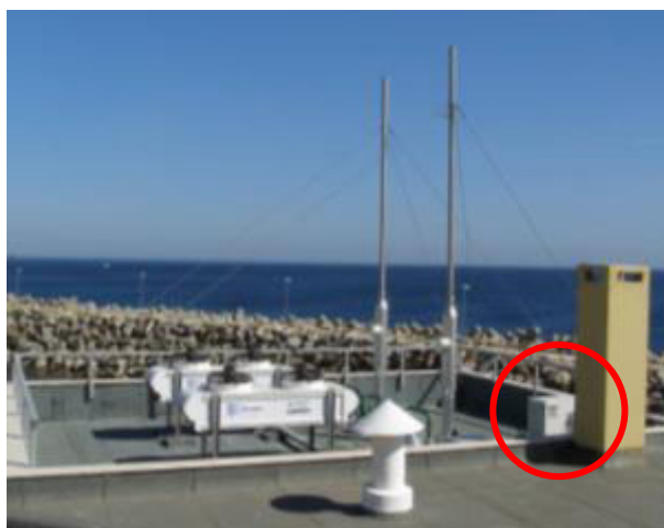
Refrigeradores e Radiadores
