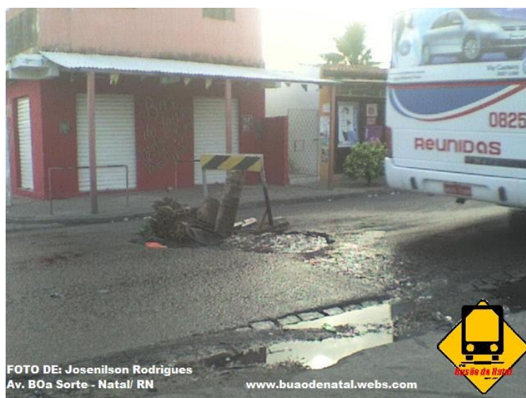
Figura 01 – Buracos na Av. Boa Sorte – Zona norte de Natal/RN. Fonte: www.busaodenatal.webs.com
