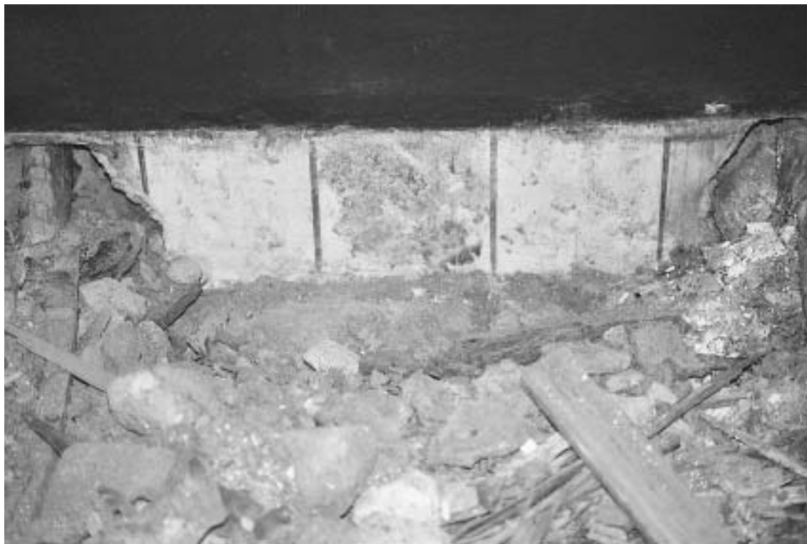
Fig. 6 Diferença altimétrica entre o pavimento actual e o anterior.
