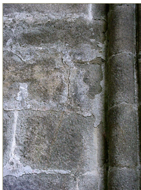
Figura 13. Capilla 2. En la imagen se observa la presencia abundante de restos de encajado en la superficie de los sillares, que aparecen asociados con costra negra. También se aprecia una de las numerosas grietas que afectan a la fábrica de sillería
