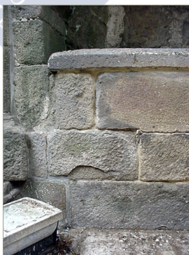
Figura 15. La suciedad es muy intensa en el monumento. En la imagen tomada en la capilla 2, se puede apreciar la abundante deposición de excrementos de aves. También se observa la formación de una gruesa separación superficial en un sillar bajo el tímpano
