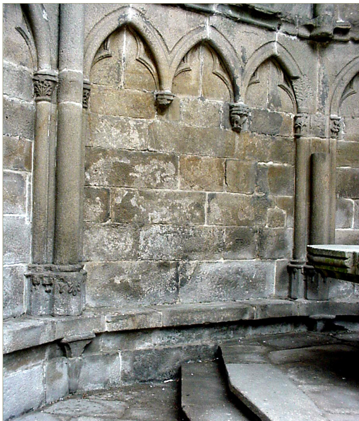
Figura 16. Se observa en detalle el importante deterioro de uno de los paños de la capilla 3 afectado por costras negras, humedad y separaciones superficiales. La humedad en los muros y en el enlosado es patente en esta imagen
