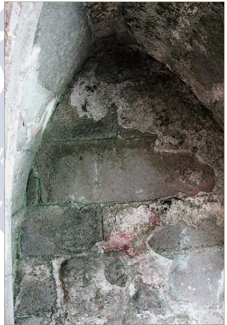
Figura 26. Restos de los frescos en uno de los paños apuntados de las capillas
