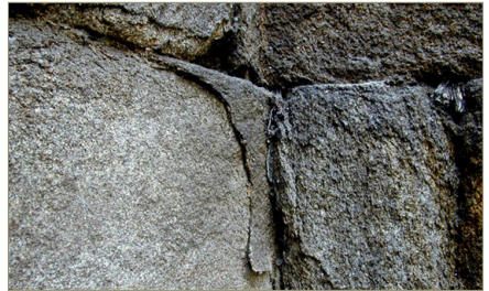
Figura 2. Detalle de la desplazación que afecta a la roca en muchos lugares de este monumento. La placa de la imagen se desarrolla en el muro exterior del recinto, en los paños de la capilla 3
