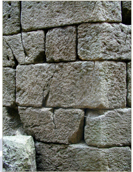
Figura 5. Detalle de las múltiples grietas verticales que afectan a la sillería de la parte posterior del muro del rosetón
