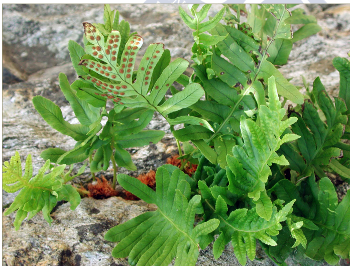
Figura 32. Ejemplar de Polypodium sp. creciendo en una de las grietas
