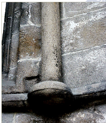
Figura 11. Imagen del exterior de la capilla 1, en donde se aprecia la intensa costra negra de contaminación en los sillares más cercanos al suelo.
