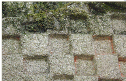
Figura 20. Detalle de la limpieza en seco de la parte central; al hacer la limpieza en seco de forma controlada, salen a la luz numerosos restos de pigmento rojo
