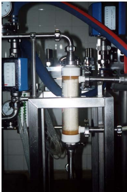
Figura II.4. Membrana de microfiltración instalada en la unidad piloto.
