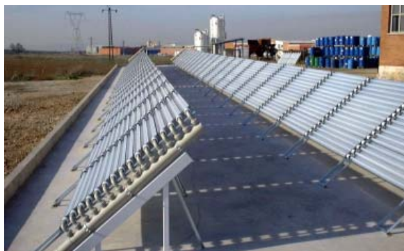
Figura 1.14. Planta experimental industrial de fotocátalisis solar (Arganda del Rey, Madrid).
