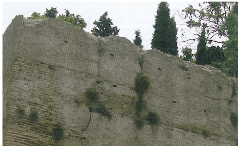
05.06. Erosión de la coronación del muro debida a la acción de los agentes atmosféricos, Mileto, C. & Vegas, F. (edit.) (2014). La restauración de la tapia en la Península Ibérica. Criterios, técnicas, resultados y perspectivas . Valencia: TC Cuadernos, p. 55.
