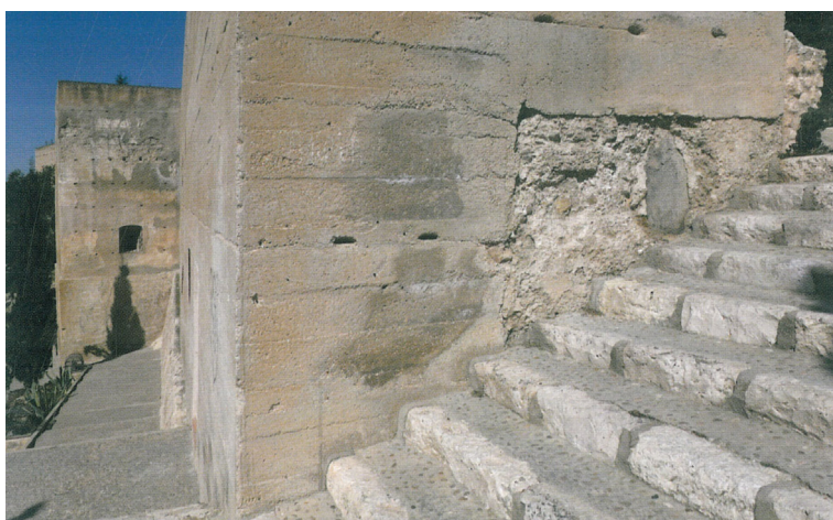
05.01. Erosión de la base del muro por subida de agua por capilaridad, Mileto, C. & Vegas, F. (edit.) (2014). La restauración de la tapia en la Península Ibérica. Criterios, técnicas, resultados y perspectivas . Valencia: TC Cuadernos, p. 53.
