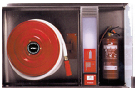
BIE 25mm con extintor, pulsador, sirena y emergencia.
