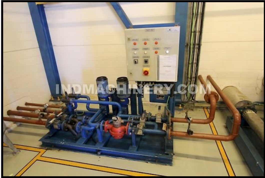
Figura 7.11: Unidad de bombeo
