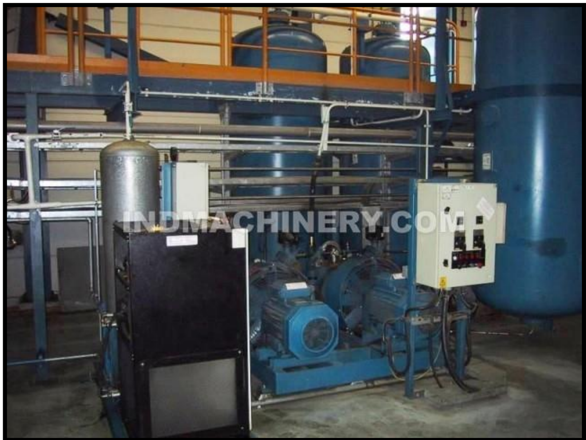
Figura 7.13: Compresores aire de arranque
