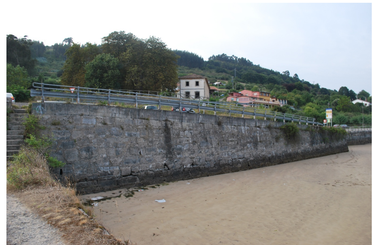
Desnivel en la conexión del dique C con tierra.
