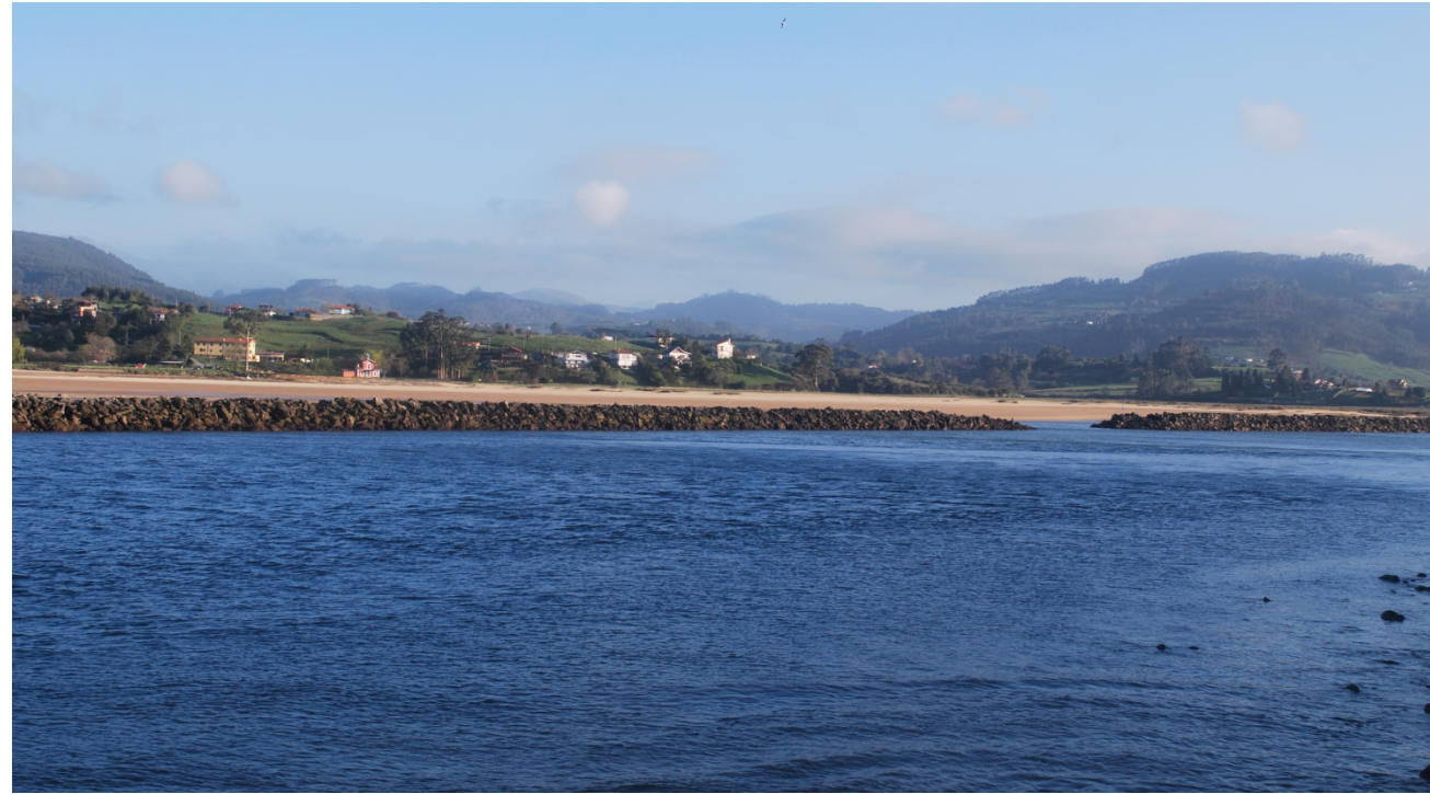
Discontinuidad dique A-B.
