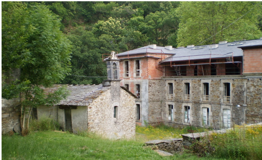
Vista actual de la capilla y la parte de la fachada posterior del balneario, paralizada la obra de su rehabilitación. ML
