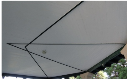
Detalle actual de la cubierta del ámbito de la fuente desde el interior. ML
