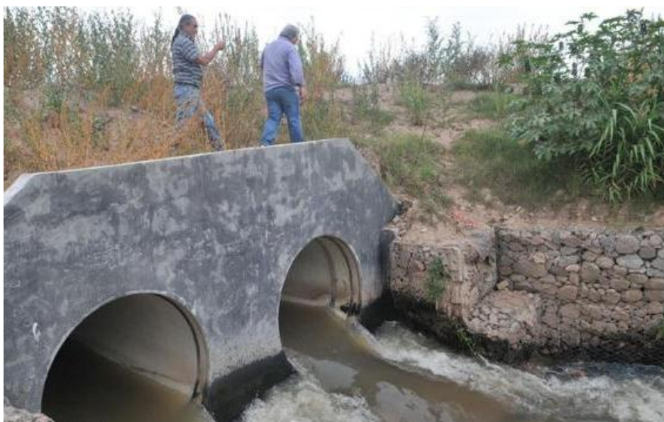
Figura 4.11.: Conductos de descarga de efluentes de la ciudad de Córdoba
