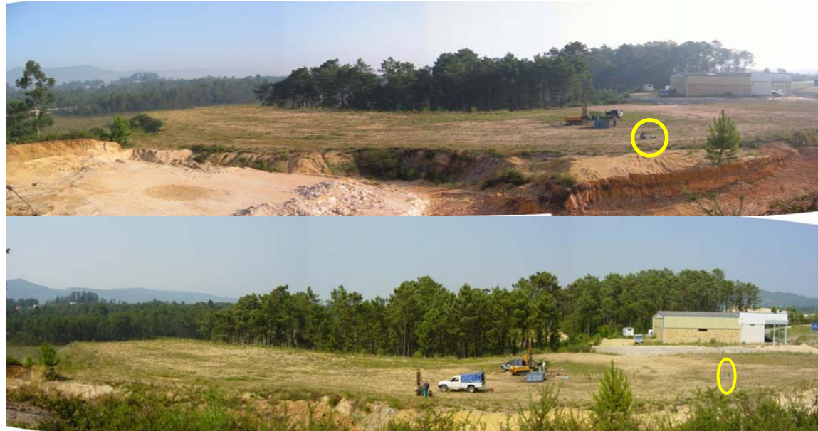
FIGURA 3.2. Vistas panorámicas del relleno sobre el que se realizaron los sondeos y ensayos penetrométricos. En la foto inferior se puede observar la ejecución del ensayo DPSH-3. En ambas fotos el círculo amarillo localiza el pozo de referencia S-1
