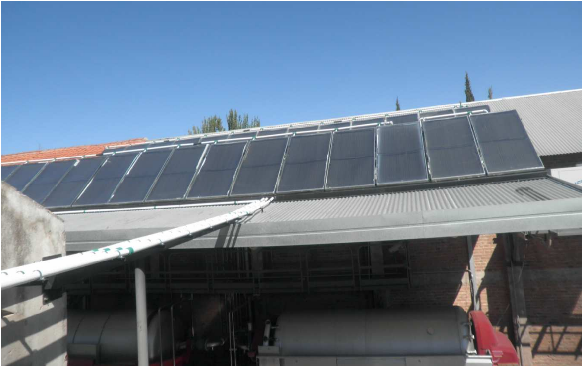
Figura 33 - Colectores solares para agua caliente industrial en Bodega Terrazas 44
