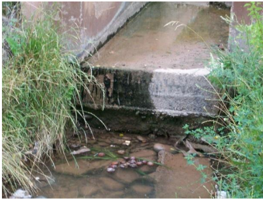
Figura 1- Transición con socavón
