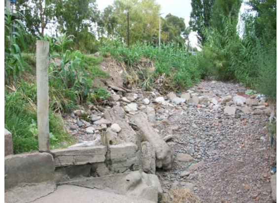
Figura 4- Rama Mathus Hoyos: colapso de obra de arte y fondo natural en canto rodado
