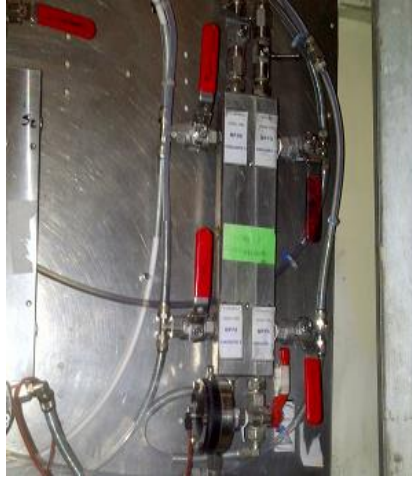
Figura 15 - Torneiras e reguladores na zona intermédia do circuito da tinta (fonte: KPP)
