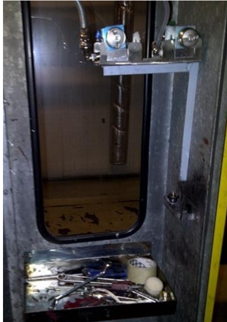
Figura 36 - Ferramentas e equipamentos na parede do acesso à cabine (fonte: KPP)
