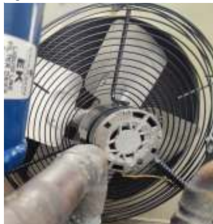
Fig. 6 Ventilador del Condensador
