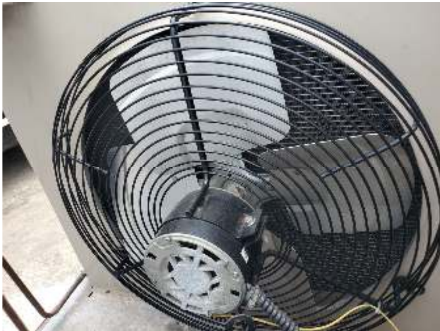
Fig 9 Ventilador del condensador
