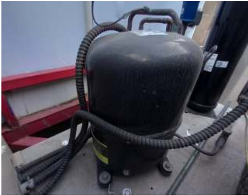
Fuente: Tecniservicios H2000
